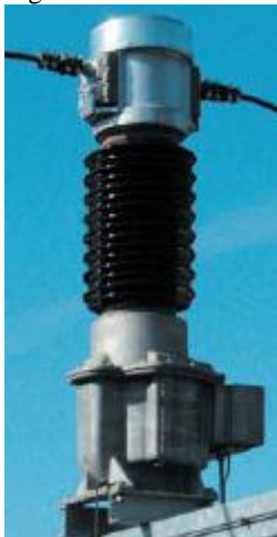
Figura 17 – Transformador de corrente instalado em subestação.
