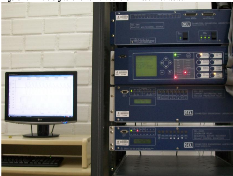
Figura 47 – Relé digital e fonte multicanal utilizados nos testes.
