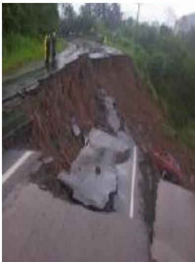
Foto 29 - Movimento de massa num talude artificial no bairro Belchior Baixo, Gaspar/SC. Fonte: Prefeitura Municipal de Gaspar, Dez/2008.
