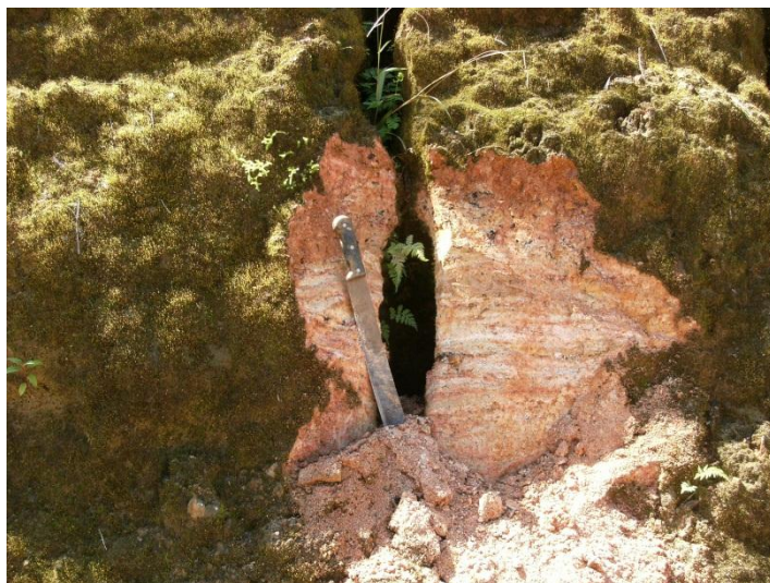
Foto 24 - Sulco provocado pelo escoamento superficial concentrado na microbacia do Rio Saltinho. O sulco aparece na parede de uma encosta onde ocorreu o escorregamento. Foto: Bini, Abr. 2010.
