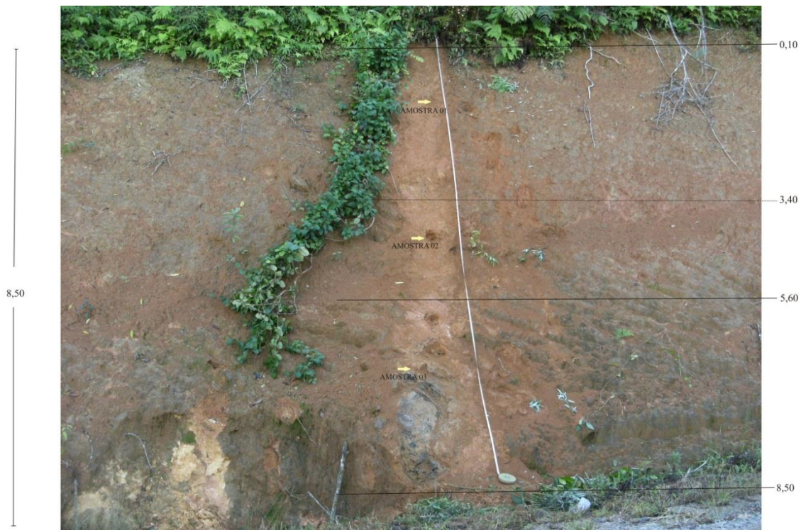
Foto 37 – Local estudo de detalhe (Perfil 03), localizado em um escorregamento no bairro Margem Esquerda. Bini, 2011.
