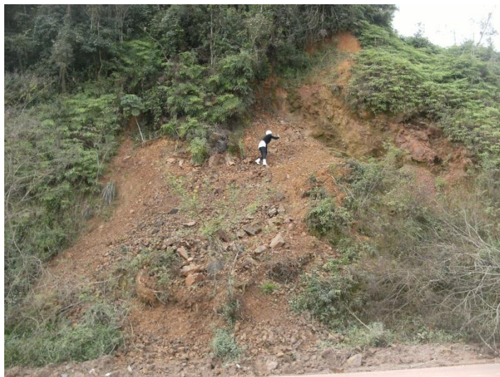
Foto 32 – Escorregamento por causa do corte na encosta na beira da Estrada Geral do Poço Grande, bairro Margem Esquerda, Gaspar/SC. Fonte: Armstrong Bini, Abr./2010.
