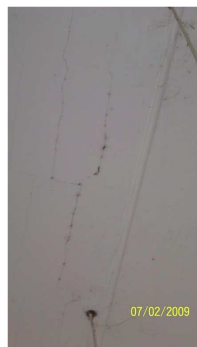
Figura 6 - Fissuras acentuadas no forro de estuque. Fonte: Sá e Oliveira (2009).
