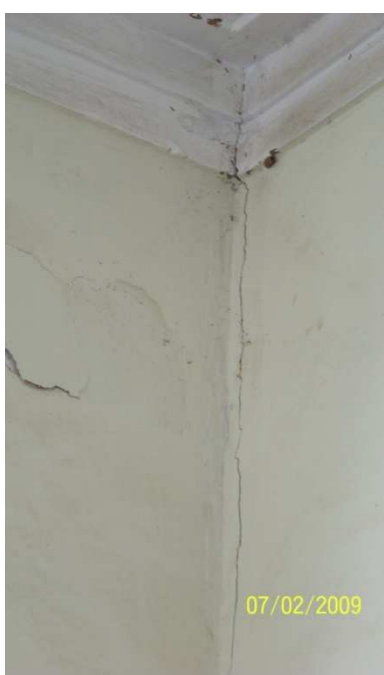
Figura 4 - Descolamento do revestimento e fissuração da alvenaria. Fonte: Sá e Oliveira (2009).
