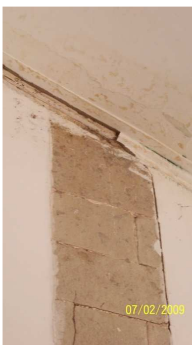
Figura 5 - Manchas, descolamento da parede e fissuração do forro de estuque. Fonte: Sá e Oliveira (2009).
