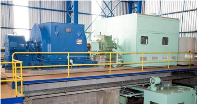
Figura 1 – Gerador Síncrono Acionado por Turbina
