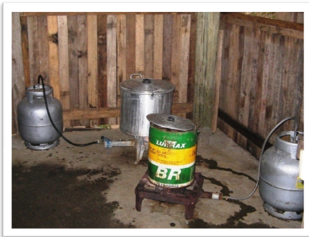
Figura 4.13 – Botijões de gás no interior das instalações (GPPPf-A). Fonte: Acervo pessoal, obtida pelo autor. 29/07/2008.
