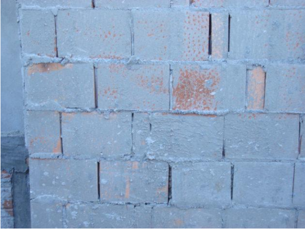
Figura 79: Parede de alvenaria estrutural com falta de modularidade e juntas verticais mal preenchidas
