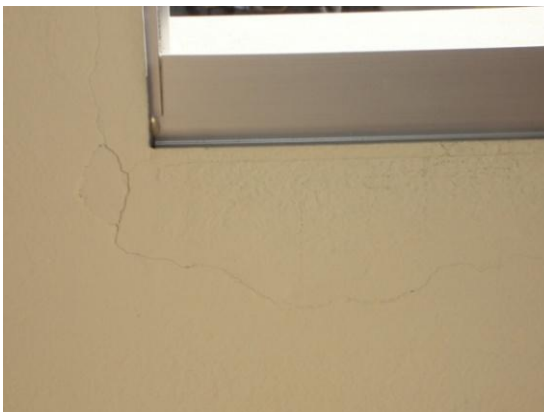
Figura 49: Fissura peitoril parede interna
