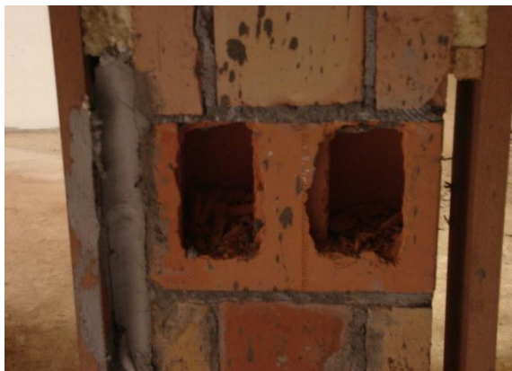
Figura 78: Quebra de bloco devido procura de eletroduto elétrico no interior da alvenaria
