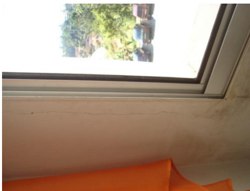
Figura 67: Fissura horizontal devido à movimentação higroscópica da alvenaria
