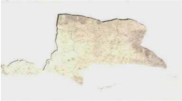
Figura 33: Forma fissura mapeada
