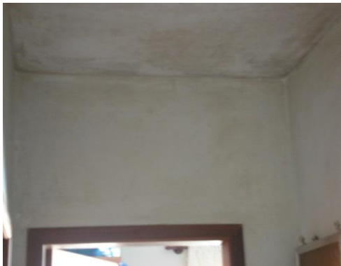
Figura 71: Mancha de umidade causada por falhas na cobertura
