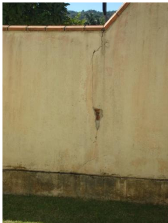
Figura 19: Fissura vertical por alturas diferentes
