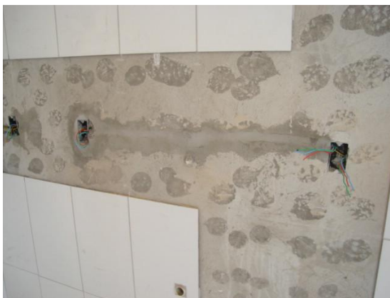
Figura 77: Rasgo horizontal devido instalação posterior de caixa elétrica não prevista
