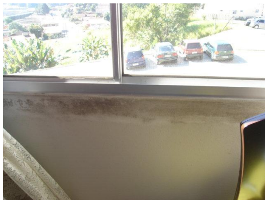
Figura 44: Manchas de umidade infiltração peitoril
