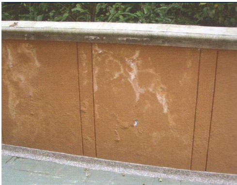
Figura 53: Eflorescência em parede pintada
