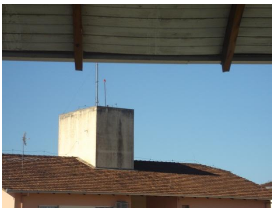
Figura 75: Mancha de umidade devido falta de detalhes construtivos que impeçam o escoamento da água da chuva pelas paredes.
