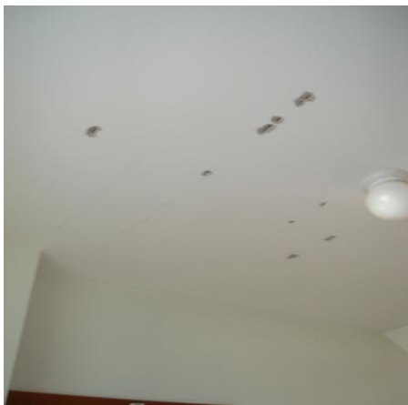
Figura 72: Armadura exposta em laje devido pequena espessura de cobrimento do concreto
