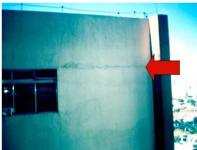
Figura 41: Fissura platibanda que possibilita infiltração na laje de cobertura
