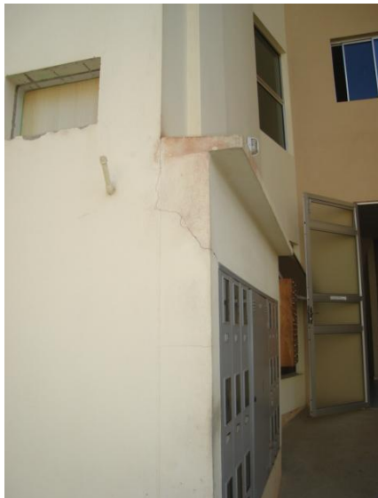
Figura 73: Fissura vertical entre parede estrutural e parede suporte Quadro de Medição
