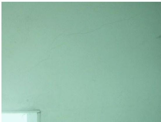
Figura 69: Fissura inclinada devido à verga inexistente ou falha
