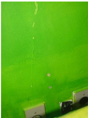
Figura 68: Fissura vertical devido à presença de conduíte embutido na alvenaria
