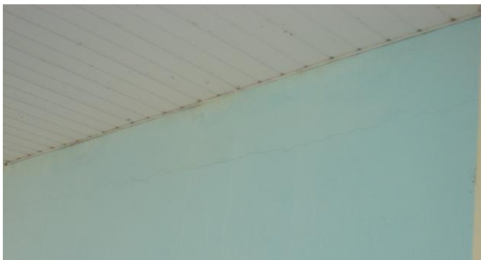
Figura 66: Fissura horizontal devido à movimentação térmica da laje de cobertura
