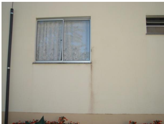
Figura 43: Manchas abaixo peitoril fachada
