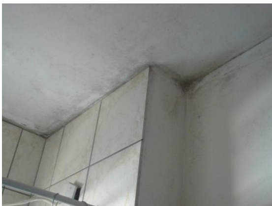
Figura 56: Laje superior com manchas pretas
