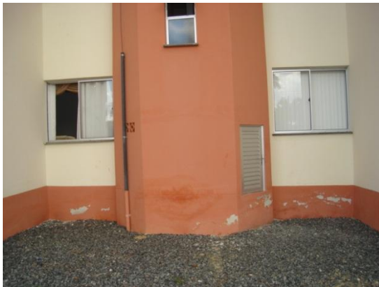
Figura 74: Mancha de umidade devido impermeabilização deficiente em viga de baldrame
