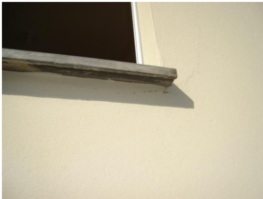
Figura 48: Fissura peitoril fachada
