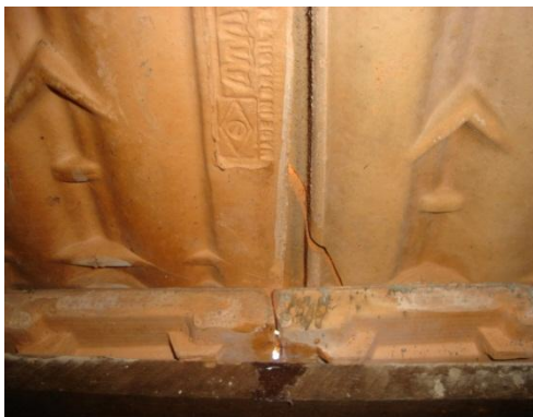
Figura 70: Telha quebrada em cobertura
