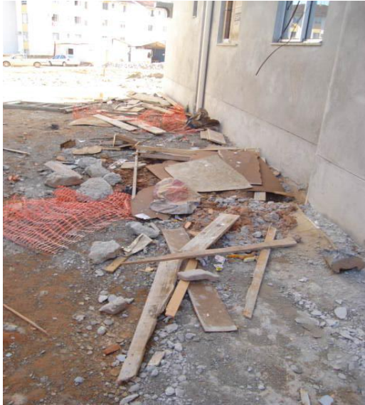
Figura 81: Canteiro de obra desorganizado do AGJ
