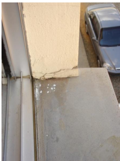
Figura 51: Fissuração na região do vórtice
