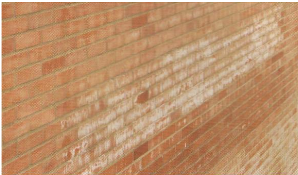
Figura 54: Eflorescência em parede de alvenaria cerâmica aparente
