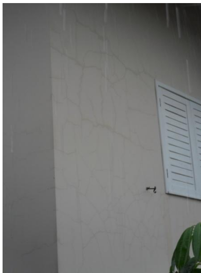
Figura 35: Parede com fissuras mapeadas (Chuva)
