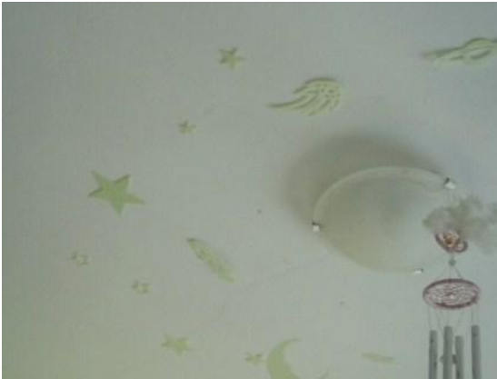
Figura 76: Fissura devido pequena espessura de cobertura de conduítes na laje
