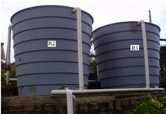
Figura 7: Reservatórios de Estabilização
