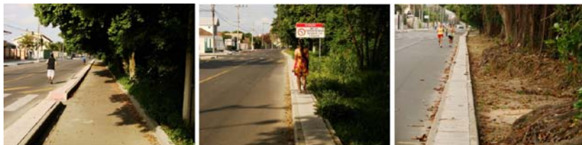
Figura 87 – Passeios inacabados tornam a circulação de pedestres e ciclistas insegura. Fotos: E. Guimarães, 2010.
