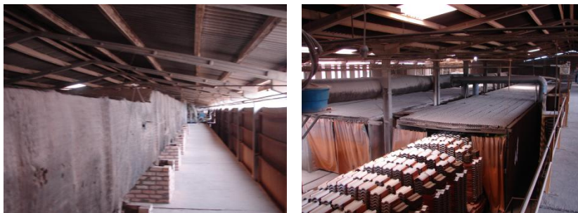
Figura 3.10 - Duto de coleta dos gases de resfriamento (esquerda) e uso no pré-aquecimento da carga (direita).
