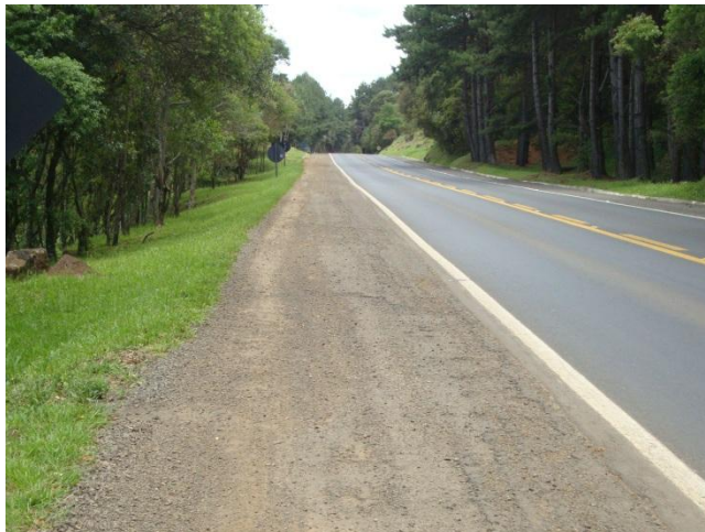
Figura 23 - Camada asfáltica danificada em acostamento da BR-116 Fonte: foto tirada pela autora da dissertação.
