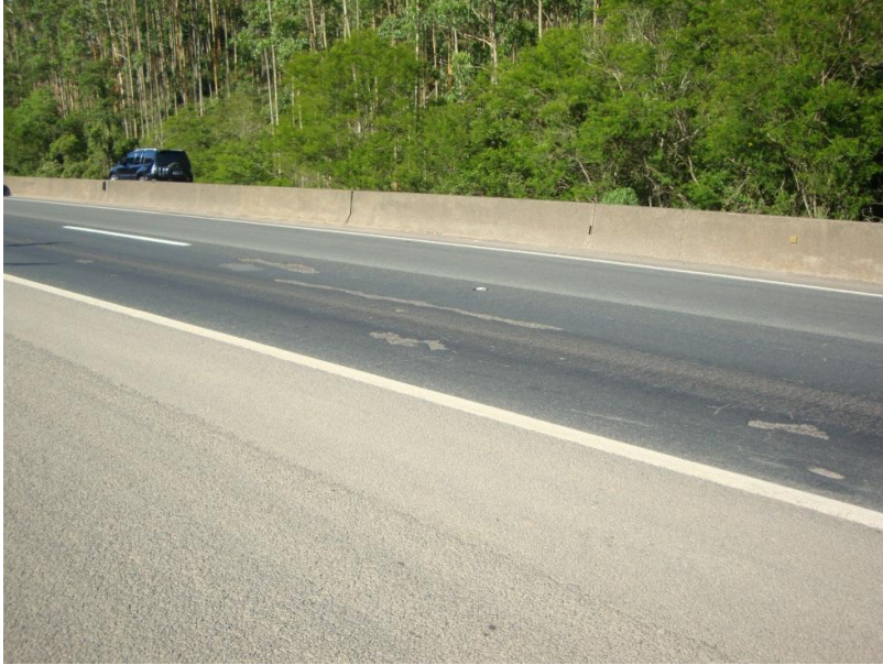
Figura 19 - Desgaste da massa asfáltica Fonte: foto tirada pela autora da dissertação.
