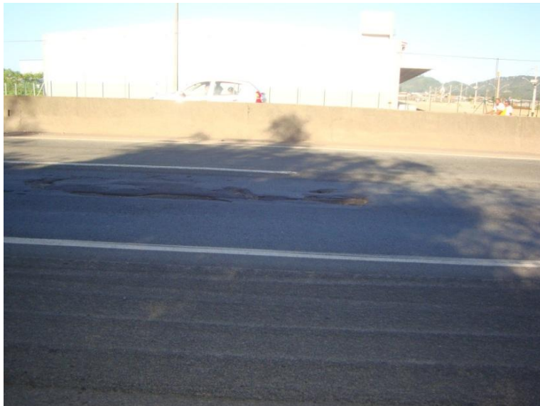
Figura 20 - Deformações plásticas no pavimento flexível próxima ao km 120 Fonte: foto tirada pela autora da dissertação.
