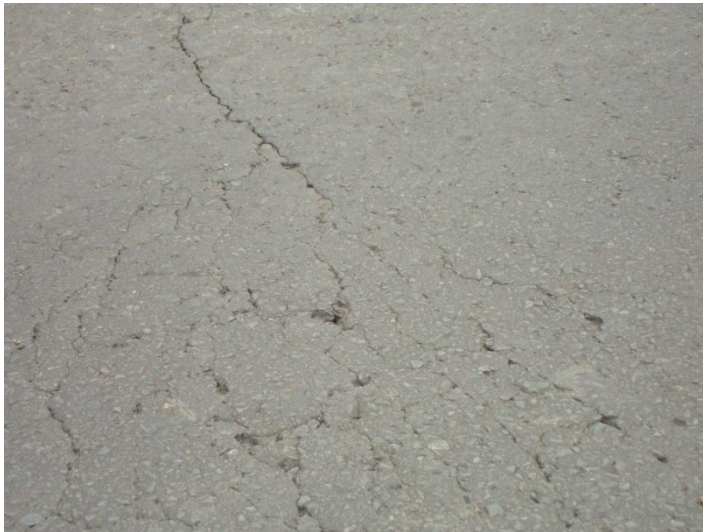
Figura 25 - Trincas no pavimento da BR-116/SC
