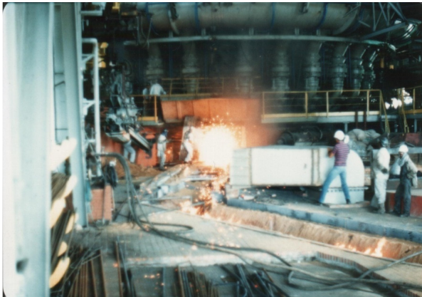
Figura 8 - Fotografia - Atividade com risco de queimaduras e de inalação de gases, em área de corrida, na segunda reforma de Alto-Forno da Siderúrgica Um.
