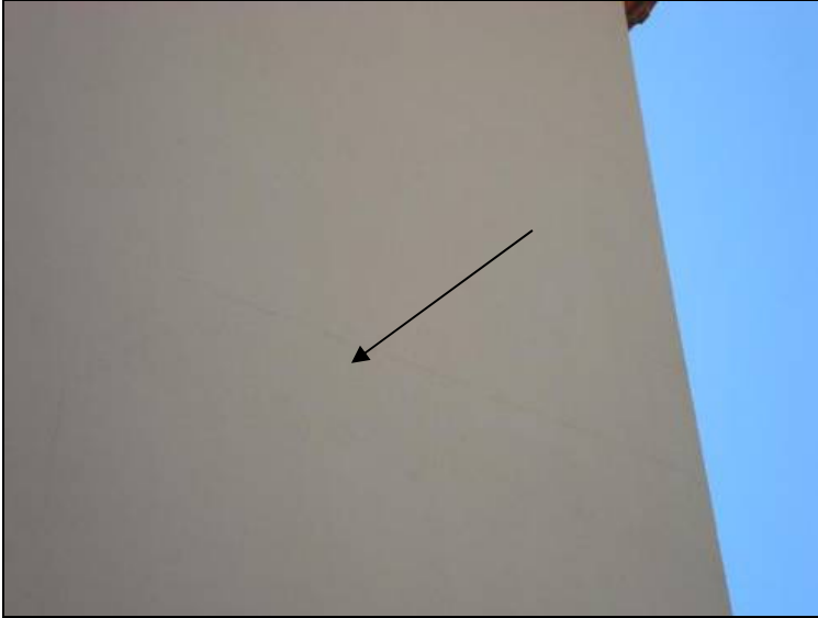
Figura 174- Patologia em fachada residencial A2. Fonte: Pesquisa de campo, 2009.
