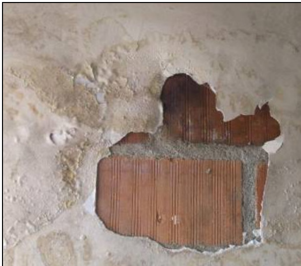
Figura 136 - Infiltração nos apartamentos do quarto andar residencial A10.
