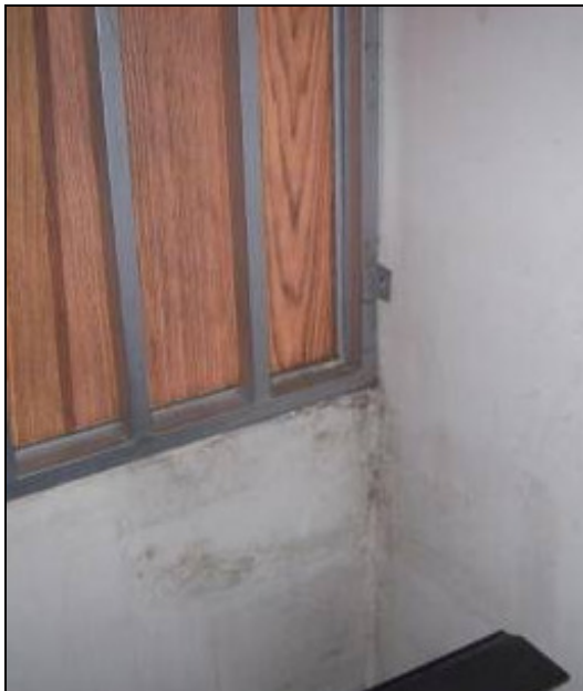
Figura 138 - Infiltrações em janelas do residencial A10. Fonte: Pesquisa de campo, 2009.
