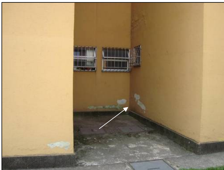
Figura 190 - Infiltração no andar térreo vindas do solo residencial A5. Fonte: Pesquisa de campo, 2009.
