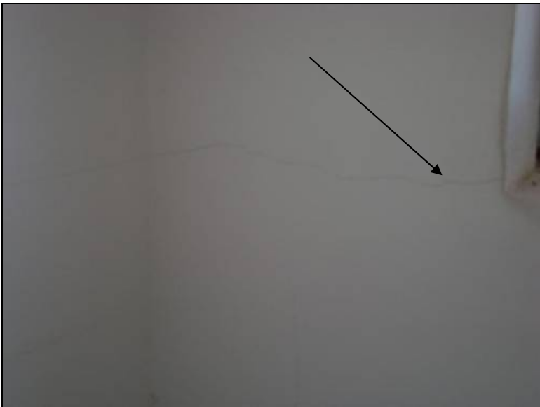
Figura 175- Patologia em fachada residencial A2. Fonte: Pesquisa de campo, 2009.
