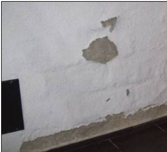
Figura 142 - Infiltração no andar térreo do residencial A10. Fonte: Pesquisa de campo, 2009.
