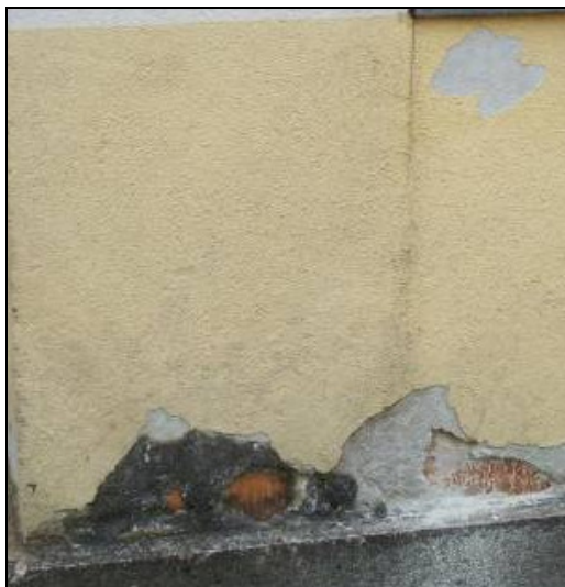
Figura 139 - Infiltração no andar térreo do residencial A10. Fonte: Pesquisa de campo, 2009.
