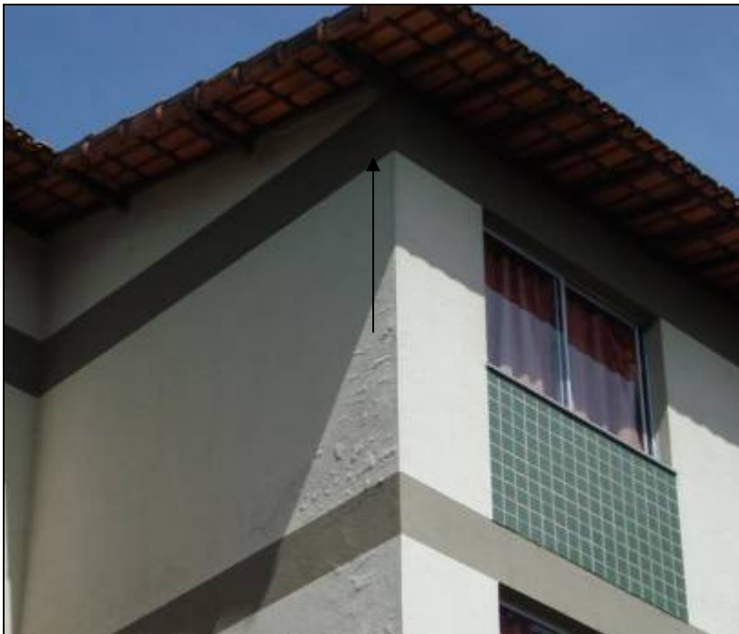
Figura 120 - Junta de dilatação inexistente residencial A5. Fonte: Pesquisa de campo, 2009.
