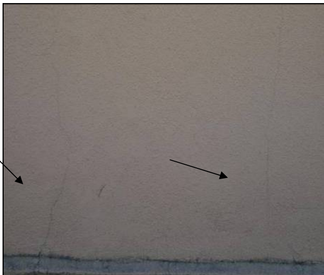
Figura 167 - Patologias na fachada residencial A1. Fonte: Pesquisa de campo, 2009.
