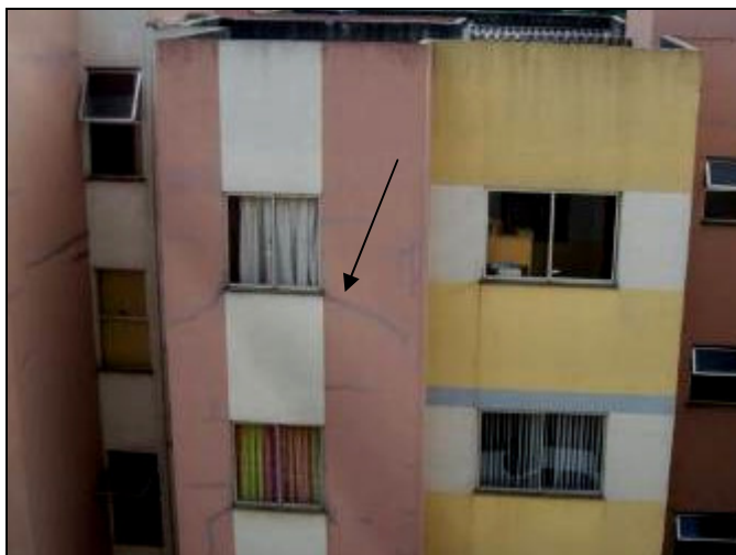
Figura 207 - Patologia em fachada do residencial A10. Fonte: Pesquisa de campo, 2009.
