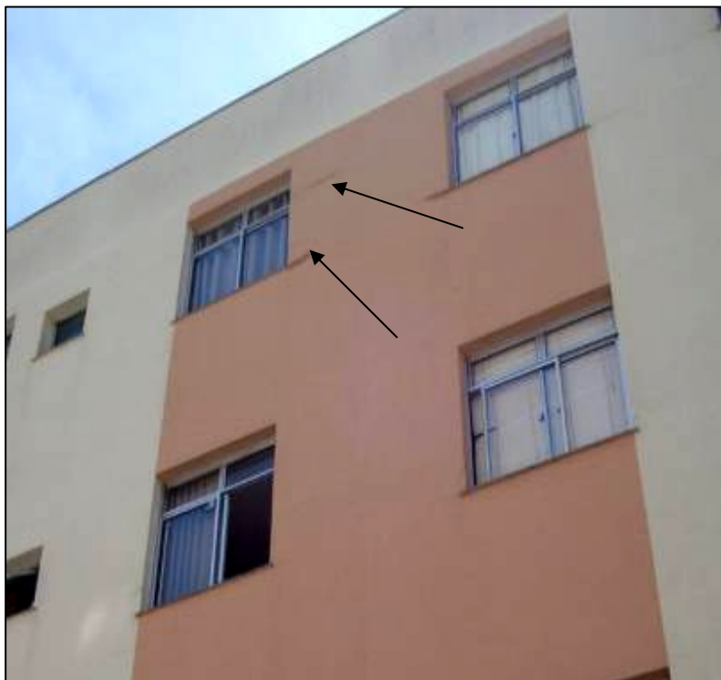
Figura 195 - Patologias em fachadas do residencial A6. Fonte: Pesquisa de campo, 2009.
