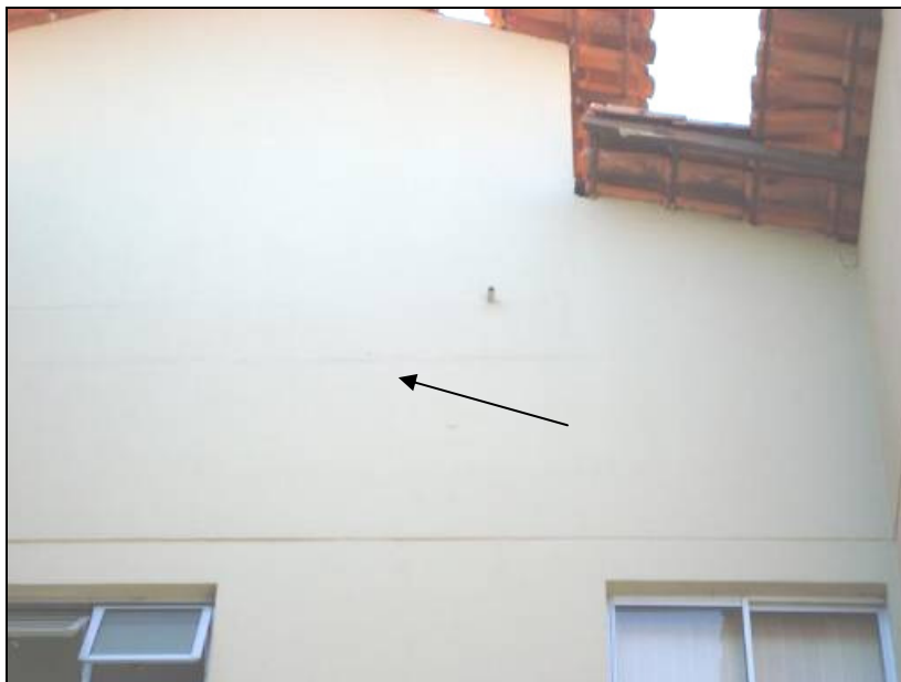
Figura 104 - Patologia em fachada residencial A2.
