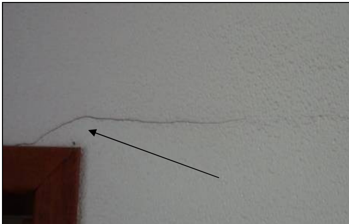
Figura 191 - Fissura do residencial A5. Fonte: Pesquisa de campo, 2009.
