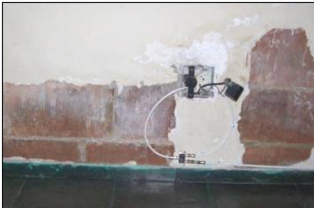
Figura 140 - Infiltração no andar térreo do residencial A10. Fonte: Pesquisa de campo, 2009.
