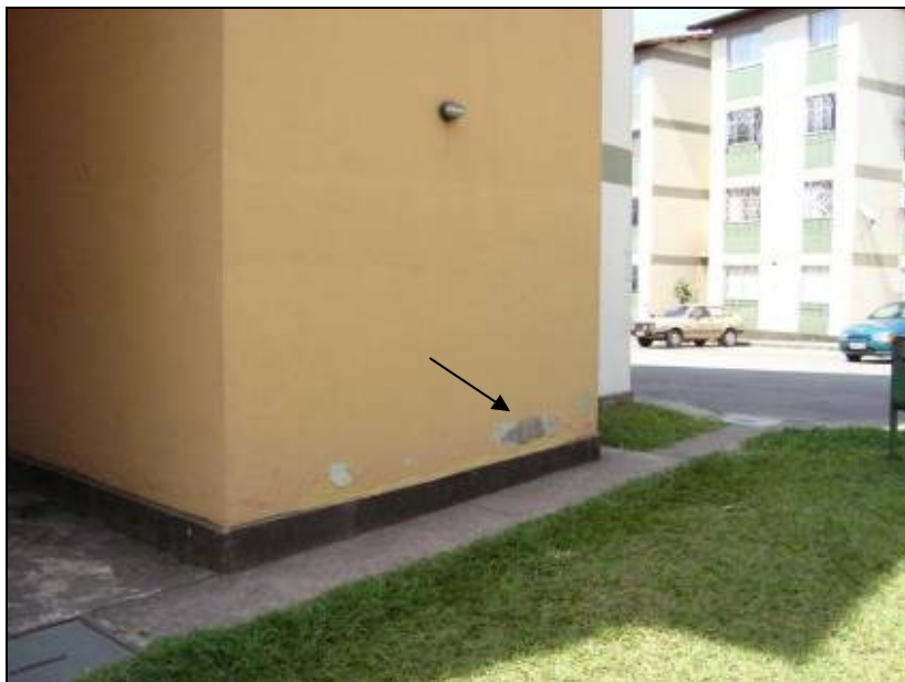
Figura 111 - Patologia em fachada do residencial A5. Fonte: Pesquisa de campo, 2009.
