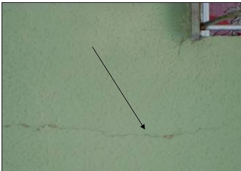
Figura 158 - Patologia em fachada residencial A13. Fonte: Pesquisa de campo, 2009.
