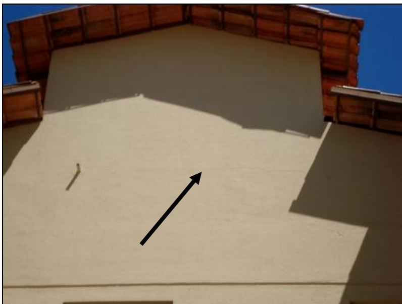
Figura 172 - Patologia em fachada residencial A2. Fonte: Pesquisa de campo, 2009.
