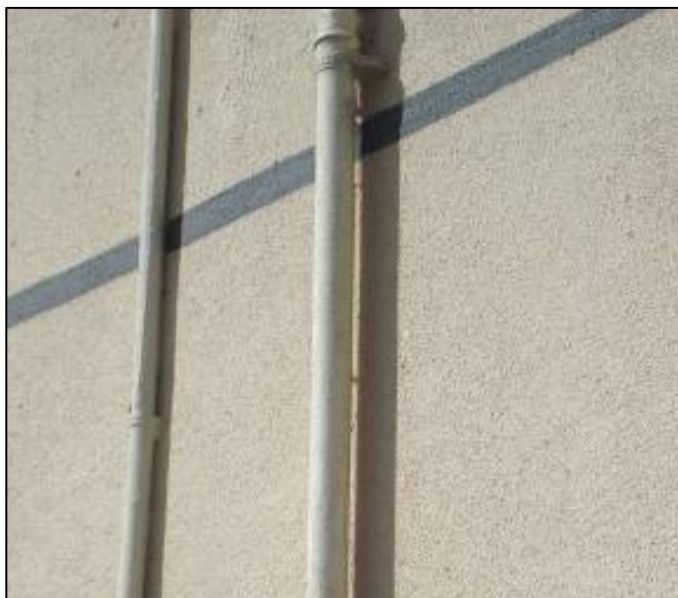
Figura 155 - Tubulações do residencial A12. Fonte: Pesquisa de campo, 2009.
