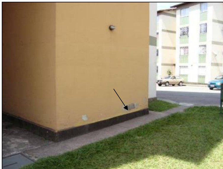
Figura 117 - Infiltração no andar térreo vindas do solo residencial A5.
