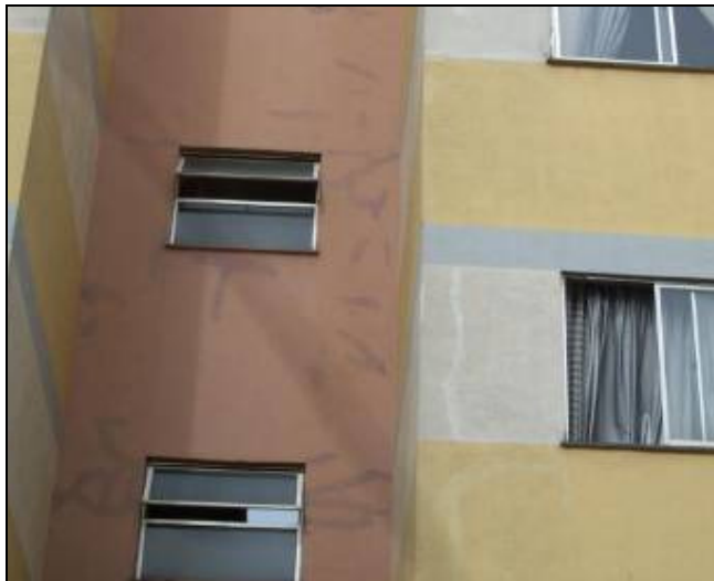
Figura 134 - Patologia em fachada do residencial A10. Fonte: Pesquisa de campo, 2009.
