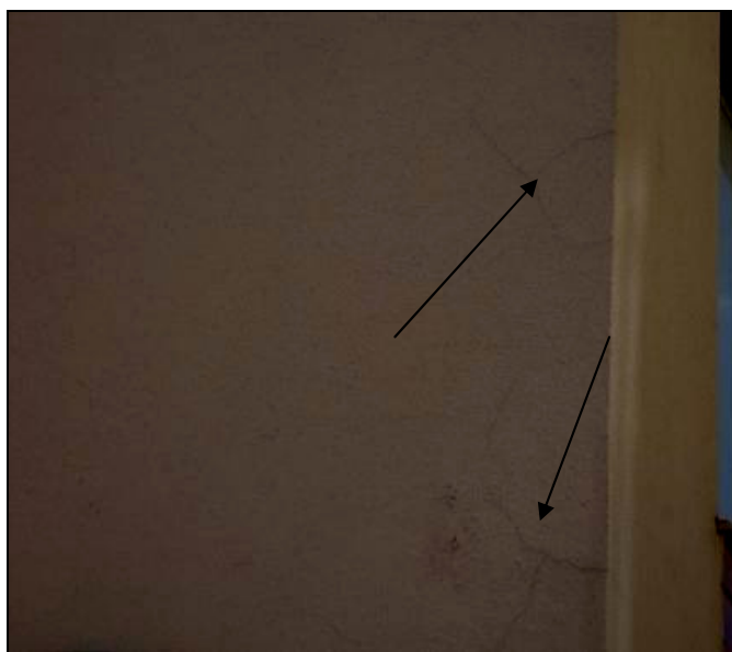
Figura 186 - Patologia em fachada do residencial A5. Fonte: Pesquisa de campo, 2009.
