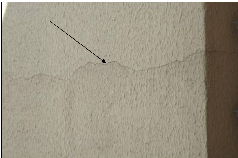
Figura 124 - Patologias em fachadas do Residencial A7. Fonte: Pesquisa de campo, 2009.
