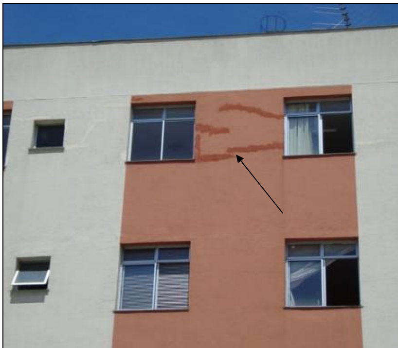
Figura 122 - Patologias em fachadas do residencial A6.
