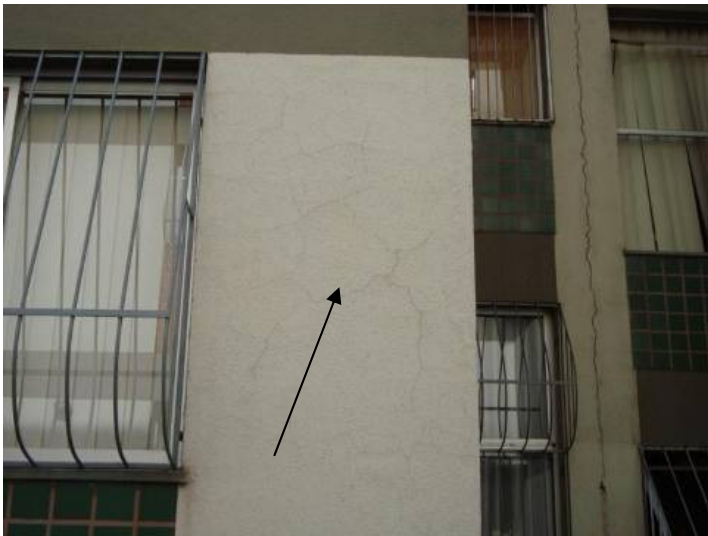
Figura 183 - Patologia em fachada do residencial A5. Fonte: Pesquisa de campo, 2009.
