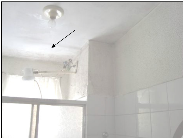
Figura 113 - Infiltração no banheiro residencial A5. Fonte: Pesquisa de campo, 2009.
