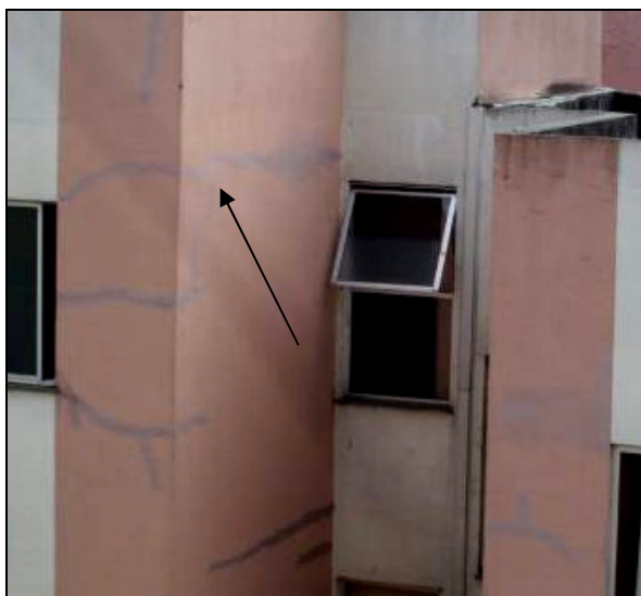
Figura 208 - Patologia em fachada do residencial A10. Fonte: Pesquisa de campo, 2009.
