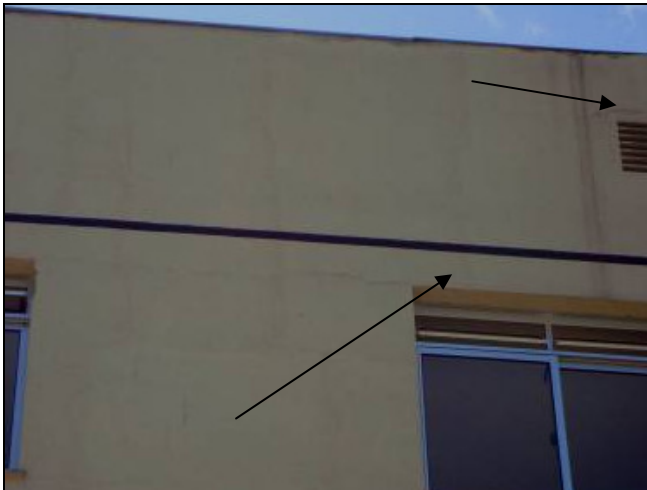
Figura 217 – Patologia da Fachada do residencial A11. Fonte: Pesquisa de campo, 2009.
