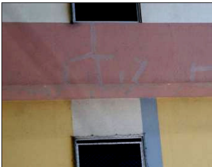
Figura 135 - Patologia em fachada do residencial A10. Fonte: Pesquisa de campo, 2009.
