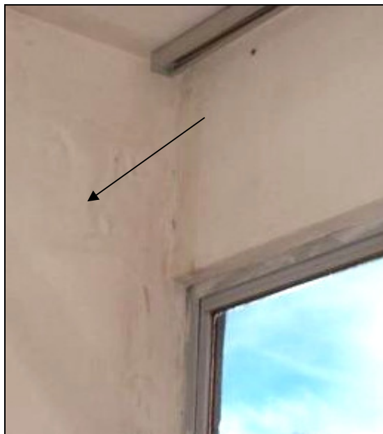
Figura 209 - Infiltração nos apartamentos do quarto andar do residencial A10. Fonte: Pesquisa de campo, 2009.
