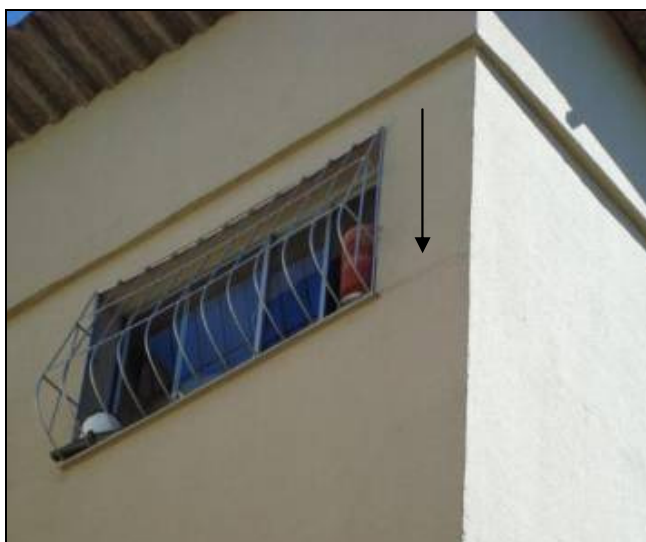
Figura 201 - Patologias em fachadas do residencial A7. Fonte: Pesquisa de campo, 2009.
