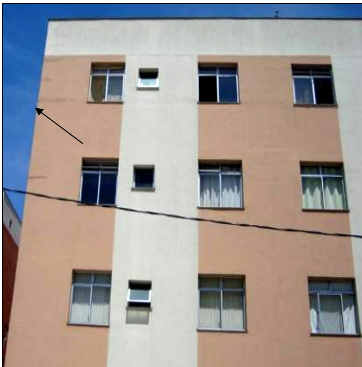
Figura 197 - Patologias em fachadas do residencial A6. Fonte: Pesquisa de campo, 2009.
