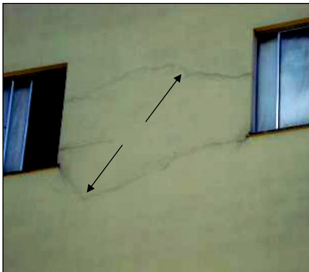
Figura 162 - Fissuras do residencial A14. Fonte: Pesquisa de campo, 2009.
