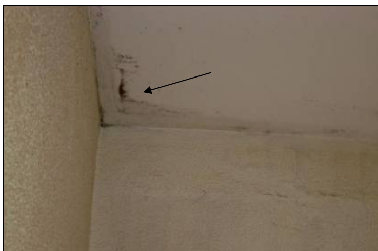
Figura 114 - Infiltração causada por vazamento no telhado residencial A5. Fonte: Pesquisa de campo, 2009.
