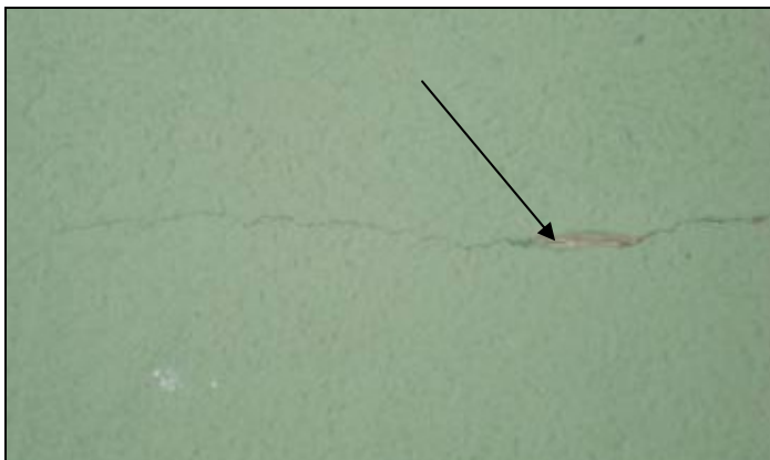
Figura 157 - Patologia em fachada do residencial A13. Fonte: Pesquisa de campo, 2009.
