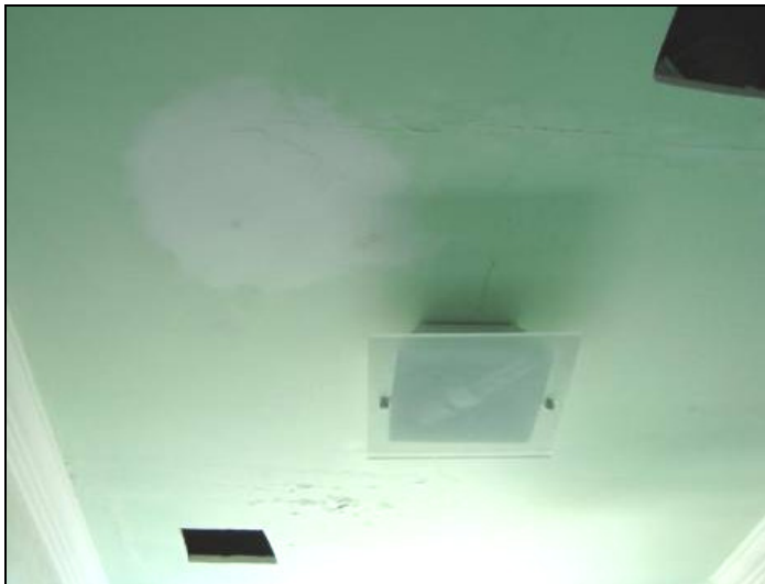
Figura 131 - Infiltração no teto residencial A8.
