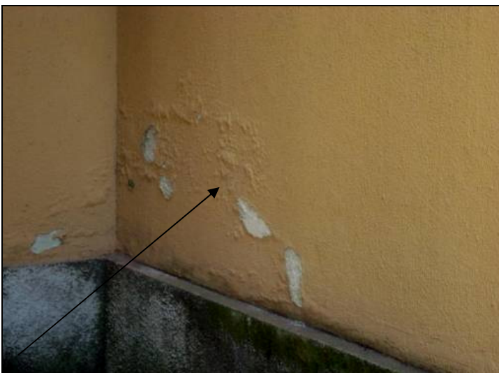
Figura 116 - Infiltração no andar térreo vindas do solo residencial A5. Fonte: Pesquisa de campo, 2009.
