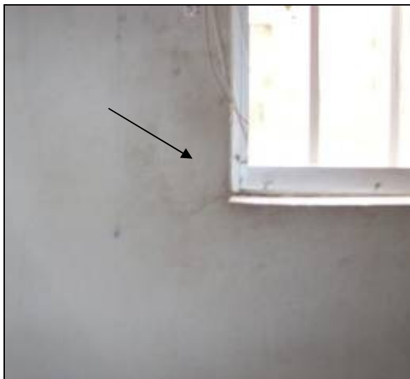
Figura 145 - Fissuras do residencial A10. Fonte: Pesquisa de campo, 2009.
