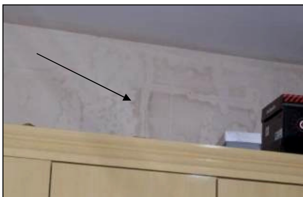
Figura 210 - Infiltração nos apartamentos do quarto andar do residencial A10. Fonte: Pesquisa de campo, 2009.
