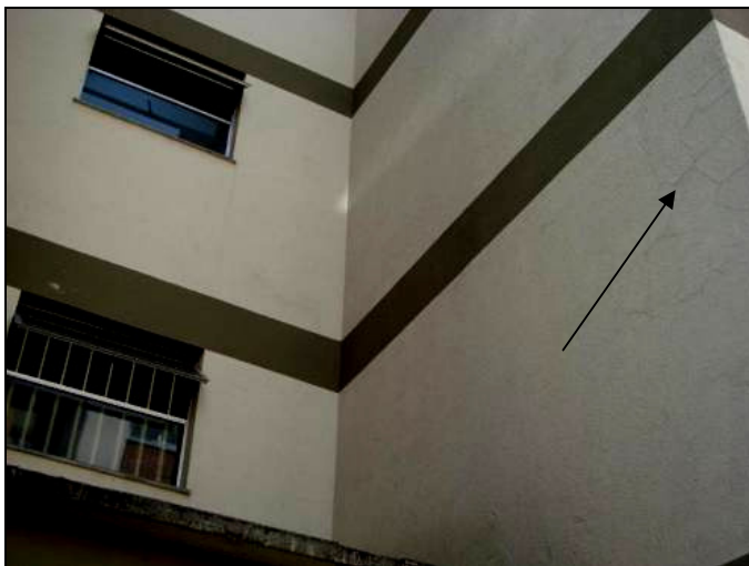
Figura 182- Patologia em fachada do residencial A5. Fonte: Pesquisa de campo, 2009.
