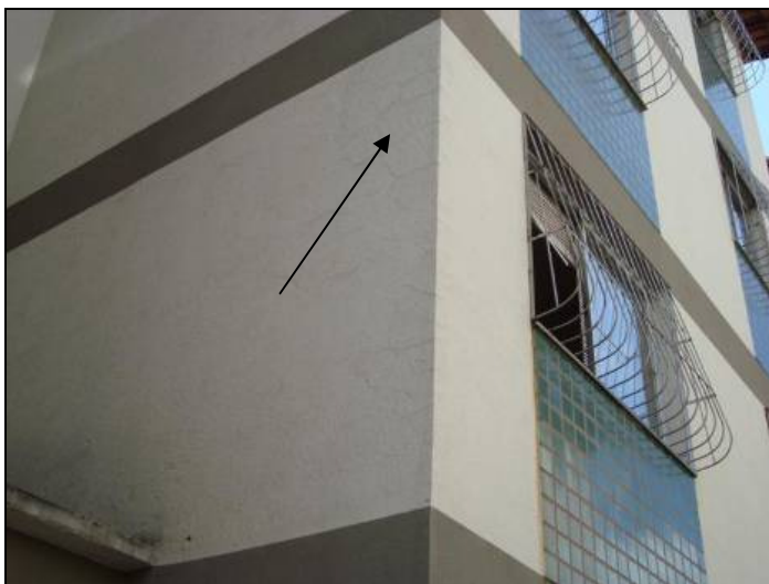
Figura 181 - Patologia em fachada do residencial A5. Fonte: Pesquisa de campo, 2009.
