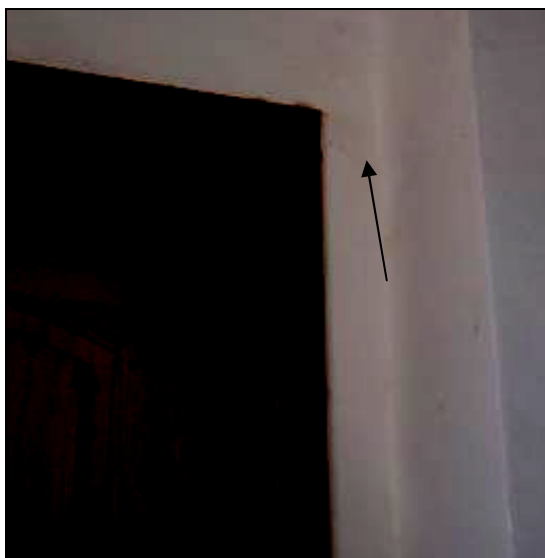
Figura 212 - Fissura do residencial A10. Fonte: Pesquisa de campo, 2009.
