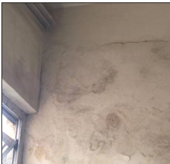
Figura 137 - Infiltração nos apartamentos do quarto andar residencial A10.
