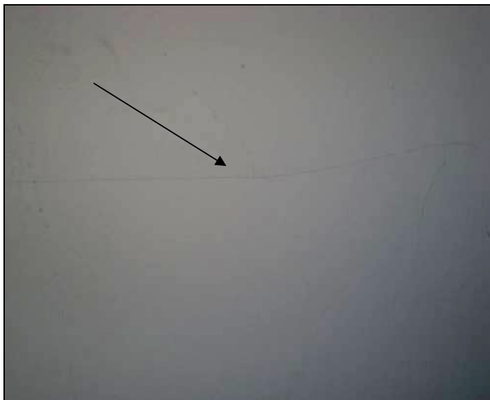
Figura 176 - Patologia em fachada residencial A2. Fonte: Pesquisa de campo, 2009.
