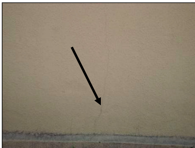
Figura 166 - Patologias na fachada residencial A1. Fonte: Pesquisa de campo, 2009.
