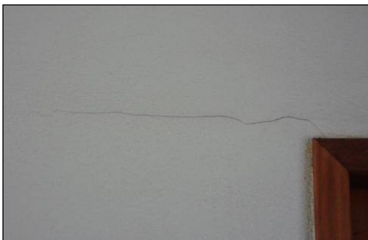
Figura 118 - Fissura do residencial A5.
