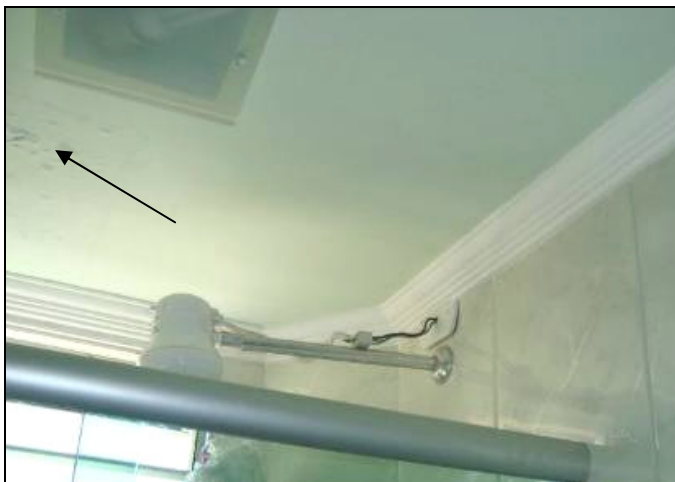
Figura 132 - Infiltração no teto do banheiro residencial A9. Fonte: Pesquisa de campo, 2009.
