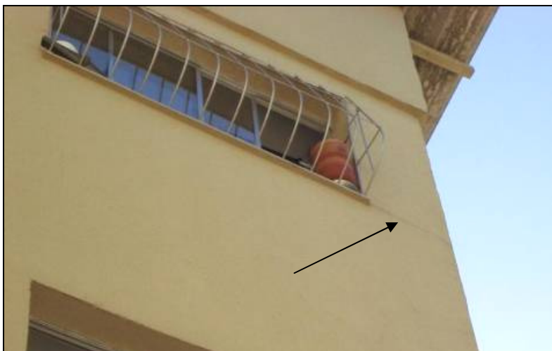
Figura 200 - Patologias em fachadas do residencial A7. Fonte: Pesquisa de campo, 2009.
