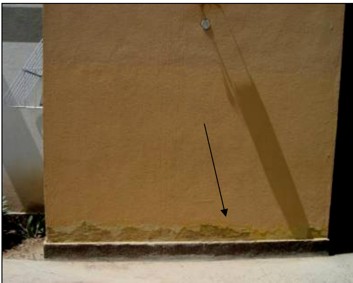
Figura 188 - Patologia em fachada do residencial A5. Fonte: Pesquisa de campo, 2009.
