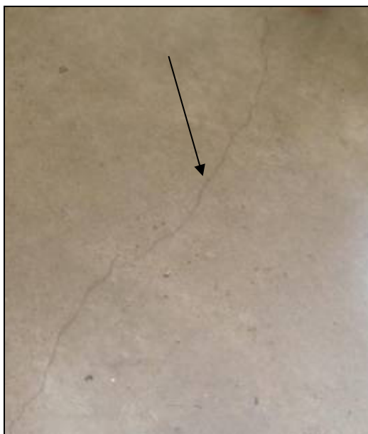
Figura 106 - Fissura no piso residencial A2. Fonte: Pesquisa de campo, 2009.
