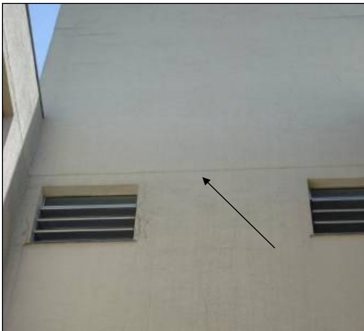
Figura 198 - Patologias em fachadas do residencial A6. Fonte: Pesquisa de campo, 2009.
