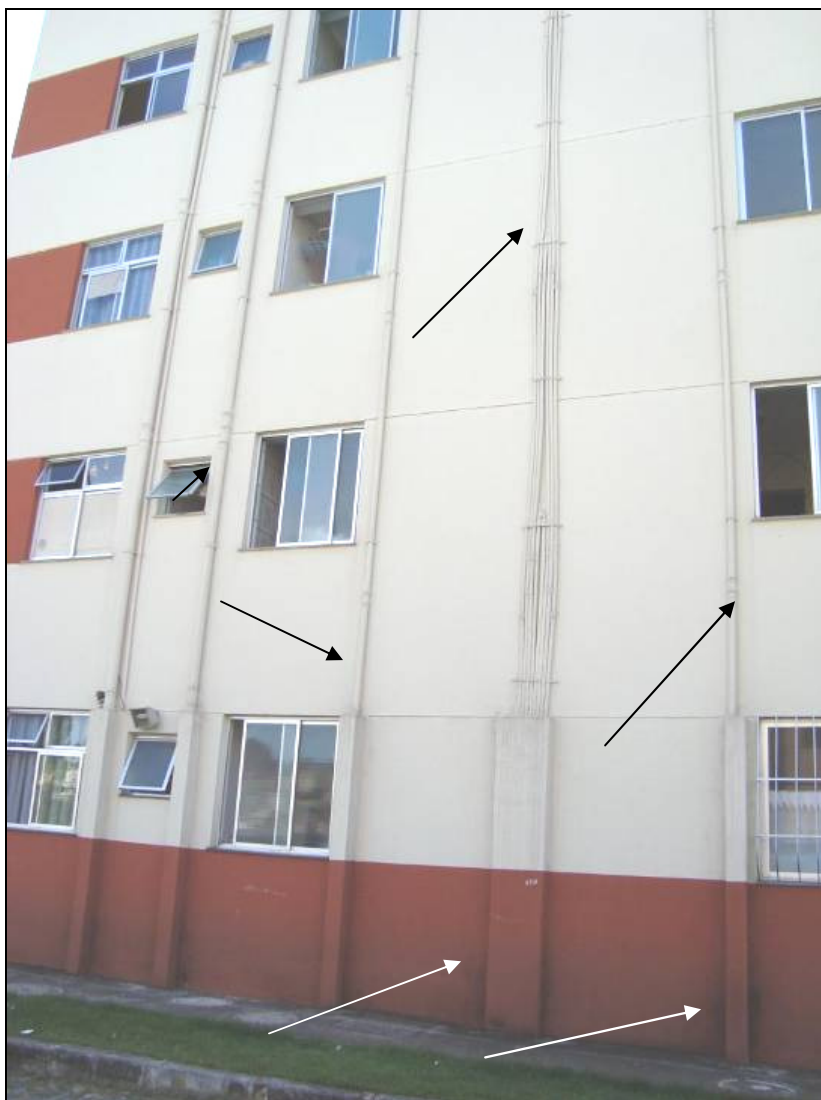
Figura 109 Tubulações externas do residencial A4. Fonte: Pesquisa de campo, 2009.
