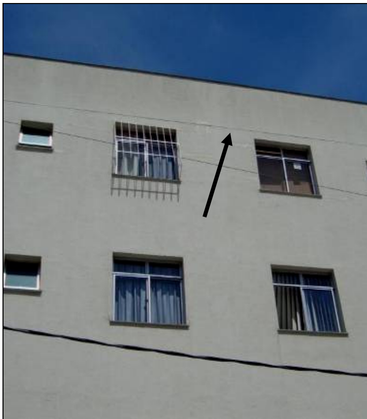
Figura 196 - Patologias em fachadas do residencial A6. Fonte: Pesquisa de campo, 2009.
