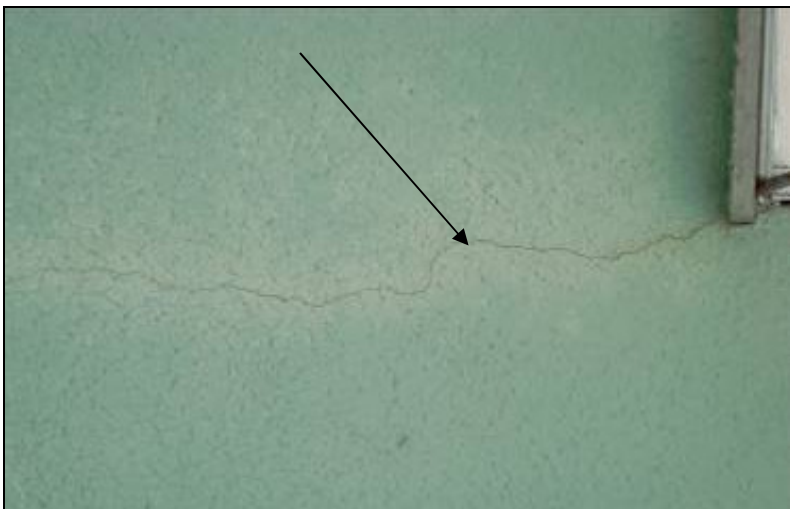
Figura 159 - Fissuras do residencial A13. Fonte: Pesquisa de campo, 2009.
