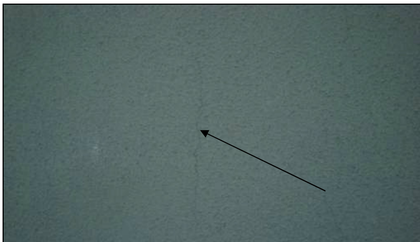
Figura 179 - Patologia em fachada residencial A3. Fonte: Pesquisa de campo, 2009.
