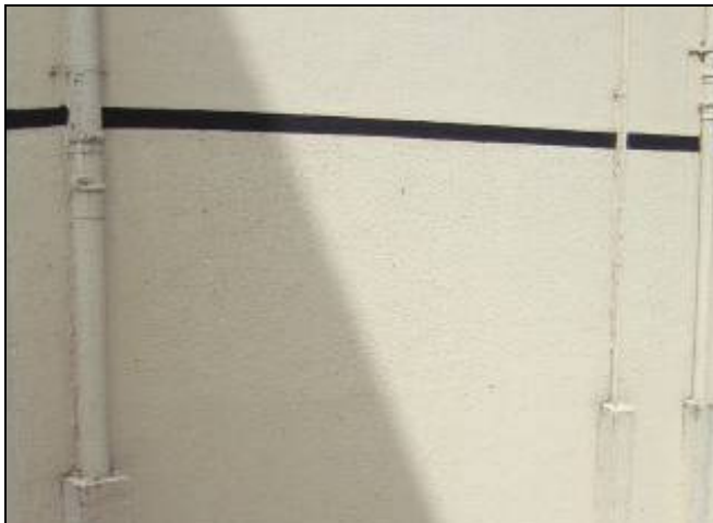
Figura 156 - Tubulações do residencial A12. Fonte: Pesquisa de campo, 2009.
