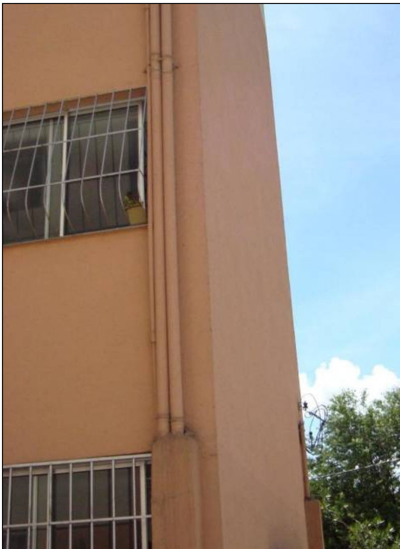
Figura 123 - Vista da instalação de tubulações externas, Residencial A6. Fonte: Pesquisa de campo, 2009.
