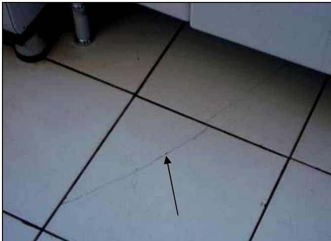
Figura 128 - Fissura no piso do residencial A7. Fonte: Pesquisa de campo, 2009.
