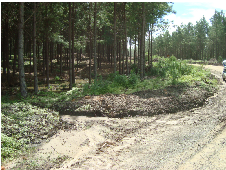
Figura 82 – Falta de manutenção de uma bacia de acumulação em campo
