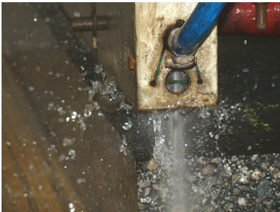
Figura 51 – Serra circular e água para resfriamento.
