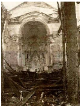
Figura 2.13 - Danos ocasionados pelo incêndio na
