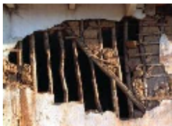
Figura 2.9 - Precariedade de parede em pau-a-pique. Fonte: GOUVEIA, 2006
