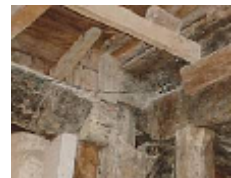
Figura 2.11 - Precariedade de uma estrutura de madeira. Fonte: GOUVEIA, 2006
