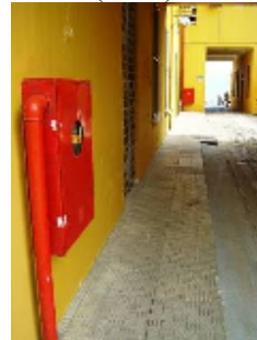
Figura 4.14 - Hidrantes compartilhados entre o Hospital de Caridade e a Capela do Menino Deus. Fonte: Autora (2008).
