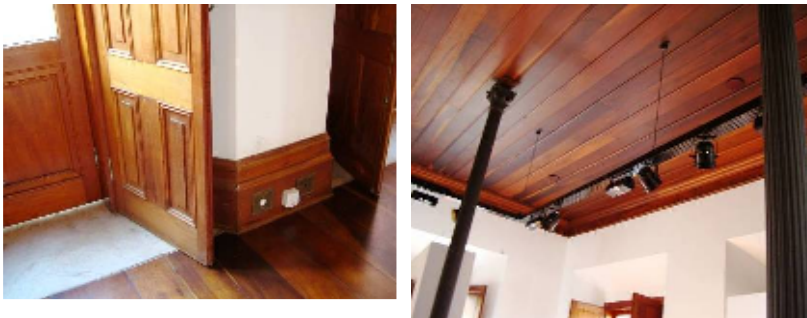
Figura 4.54 - Instalações elétricas na sala de exposições temporárias. Fonte: Autora (2009).
