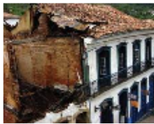
Figura 2.10 - Precariedade de um fechamento de empena em madeira. Fonte: GOUVEIA, 2006
