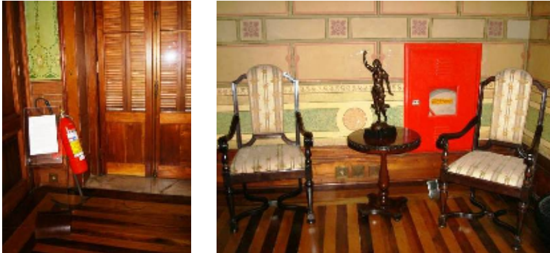
Figura 4.51 - Sistemas de proteção identificados no Palácio Cruz e Sousa. Fonte: Autora (2009).
