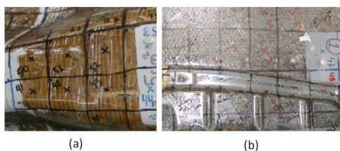
Figura 4.13: Regiões de aplicação de Manta Asfáltica. (a) Região de completa adesão da Manta à estrutura; (b) Região com problemas de adesão da Manta à estrutura
