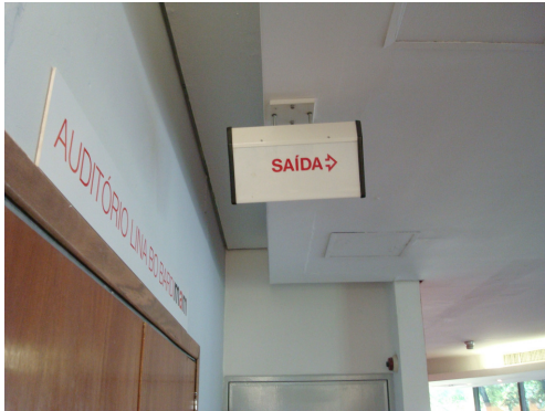
Figura 60 – Sistema de alarme sonoro e luminoso fixado no teto em gesso recém construído não afeta o patrimônio. Museu de Arte Moderna, São Paulo-SP.
