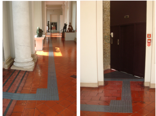
Figura 55 – Piso tátil alerta e direcional emborrachado, colado sobre o piso, aplicado em circulações horizontais. Pinacoteca do Estado, São Paulo-SP.
