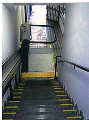
Figura 72 – Equipamento eletromecânico de circulação vertical instalado junto ao corrimão da escada e faixa antiderrapante e cromodiferenciada nos degraus. Disponível em: http://www.cmdetran.com.br/arquivos/Acessibilidade.JPG . Acesso: 08/06/2009.
