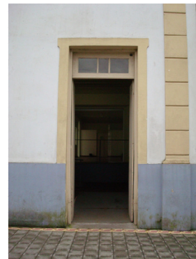
Figura 21 – Acesso lateral para pessoas com deficiências, implantado a partir da recuperação do prédio, porém sem identificação externa
