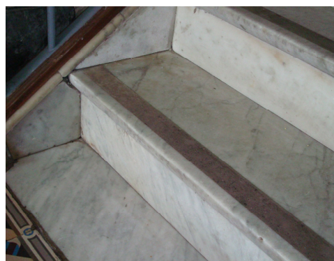
Figura 17 – Piso da escada principal em mármore que, após diversos acidentes, recebeu a inserção contemporânea de faixa de cor e textura diferenciada
