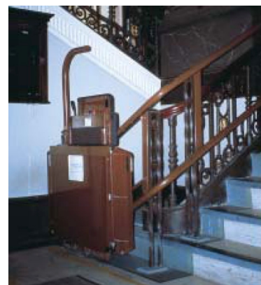
Figura 73 – Equipamento eletromecânico inserido na escada interna que liga os pavimentos e faixa antiderrapante e cromodiferenciada instalada nos degraus. Disponível em: http://www.english-heritage.org.uk/uploadpdf/EH_EasyAccess_2004.pdf . Acesso: 08/06/2009
