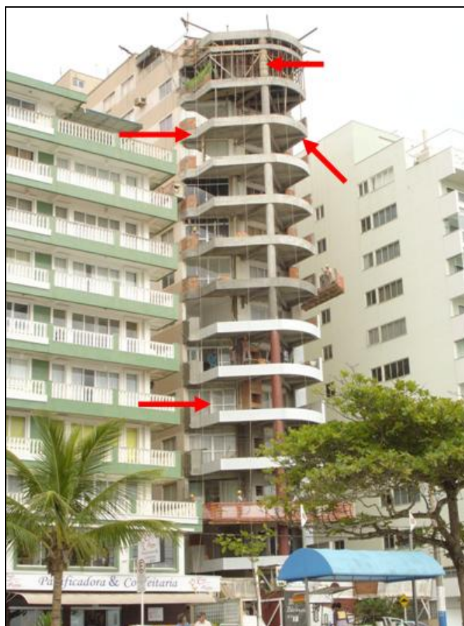
FIGURA 27 – Obra de reforma no Edifício Bahia Blanca (Avenida Atlântica, nº 1.670), adequando o patrimônio construído aos atuais padrões estético-funcionais. Fonte: Marcelo Danielski (dezembro de 2008)
