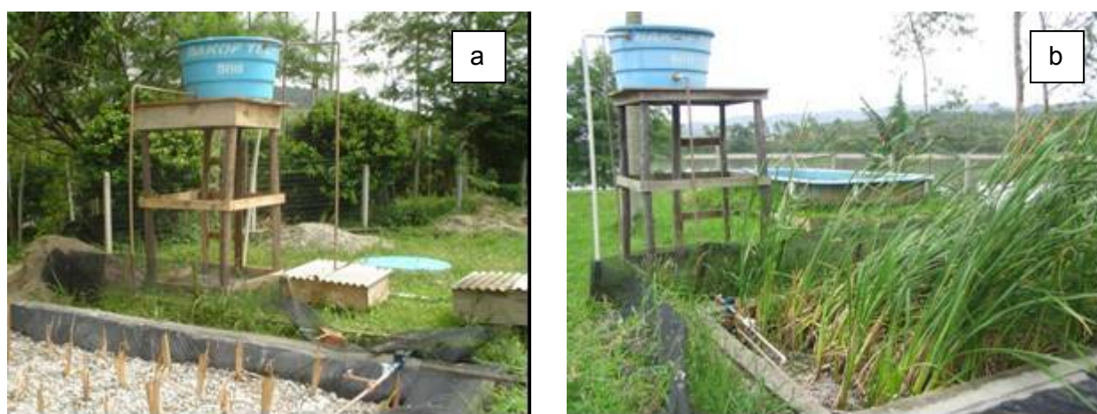
Figura 15: a) Caixa de mistura M 1-2 enterrada; caixa de equalização elevada e filtro H 1 ; b) Caixa de equalização elevada e filtro H 2 .
