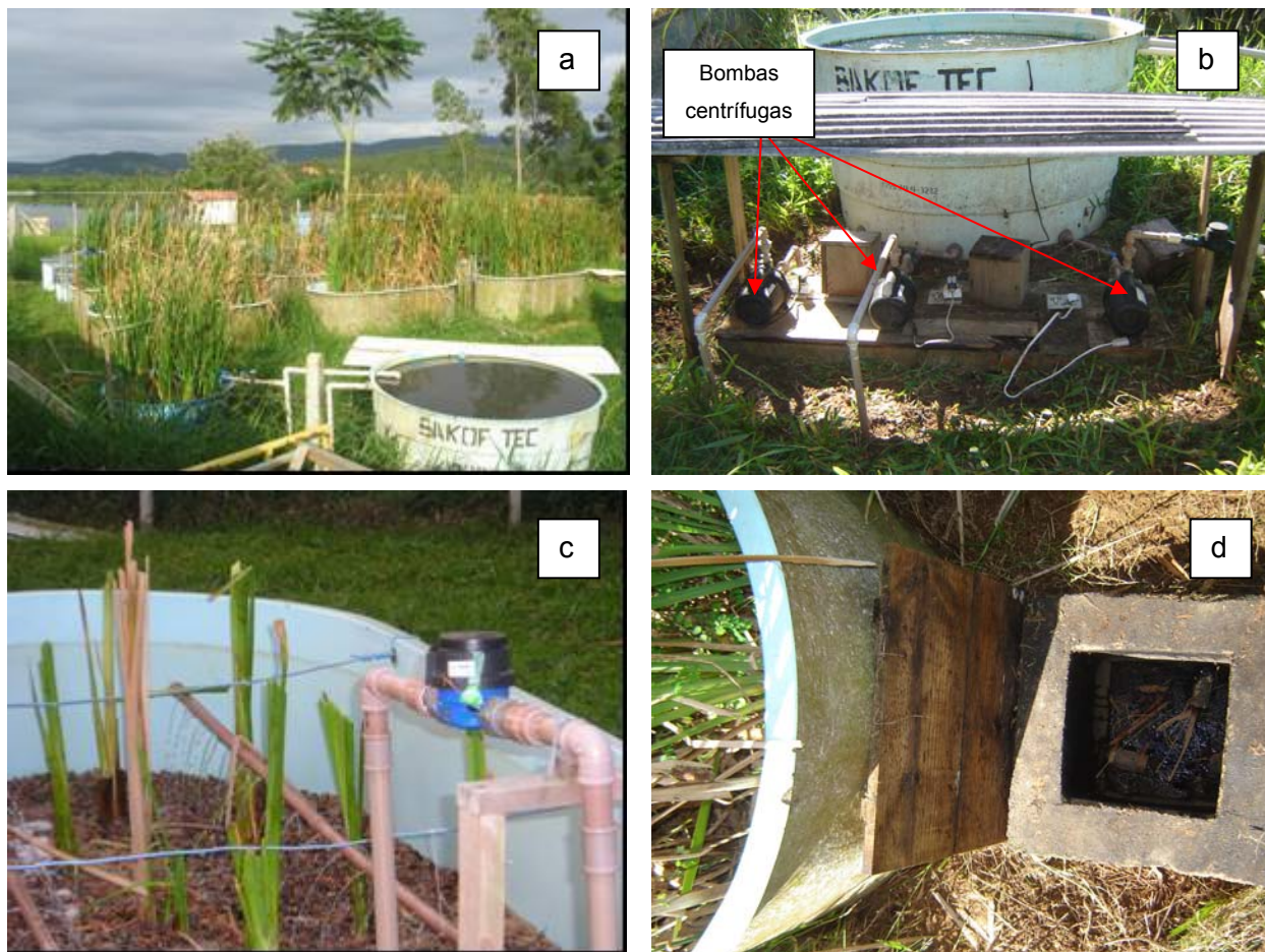
Figura 12: a) Caixa equalizadora; b) Bombas centrífugas; c) Tubulação de alimentação com detalhe para o hidrômetro; d) Caixa de coleta do efluente.
