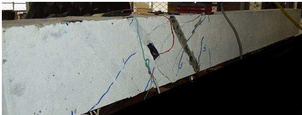
Figura 6.6- Viga 9 após o ensaio
