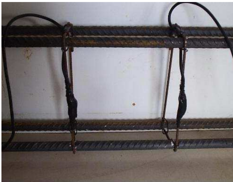
Figura 5.12 - Detalhe dos estribos com sensores
