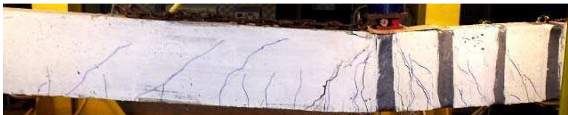
Figura 6.75 – Panorama de fissuração da Viga V29.
