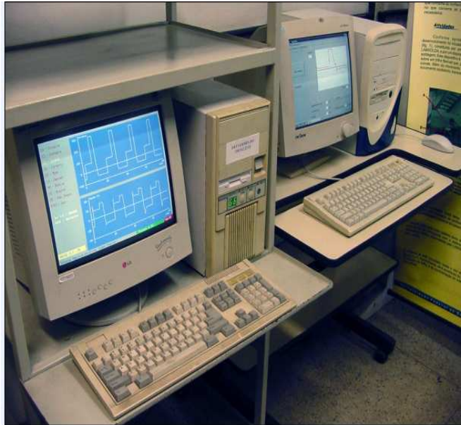
Figura 4.5 - Conjunto SICA – Sistema Integrado de Controle e Aquisição
