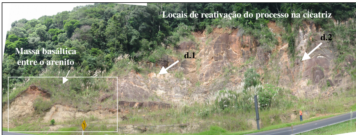
Figura 9: Cicatriz de deslizamento de maior área exposta. Ocorrido em abril de 1998, nas margens da rodovia BR 277. Na figura é possível observar novas movimentações dentro da cicatriz (d1 e d2 ver ampliação nas figuras 10 e 11, abaixo). O detalhe selecionado é mostrado de modo ampliado na figura 12.
