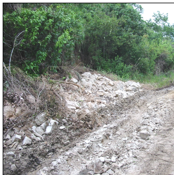
Figura 32 e 33: Deslizamento do arenito Rio do Rasto. Margens da antiga rodovia (ao Sul). Nota-se a obstrução do trânsito neste local, devido aos blocos de arenito mobilizados. Foto: Joel Pellerin (Março de 2007).
