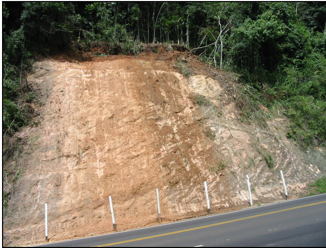
Figura 14: Deslizamento translacional raso no Arenito Botucatu. Próximos a cicatriz de deslizamento de 1998. Com aprox. 3m de altura. Foto: Joel Pellerin (Março de 2007)
