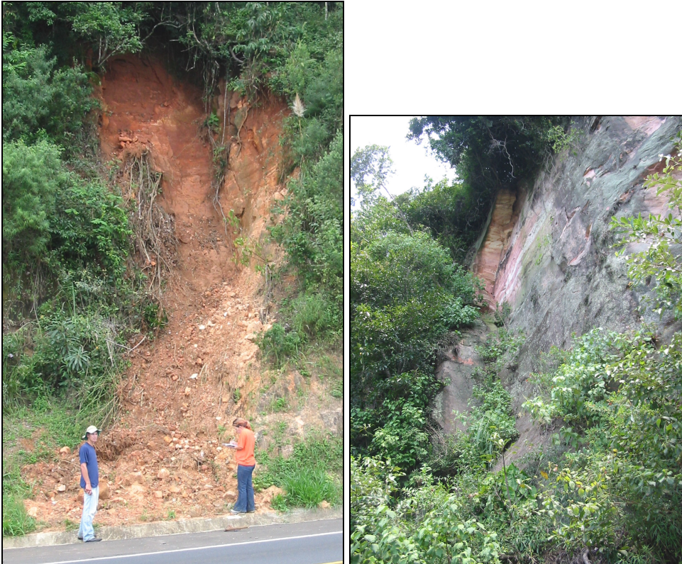
Figura 18: Deslizamento e queda de blocos no Arenito Botucatu.
