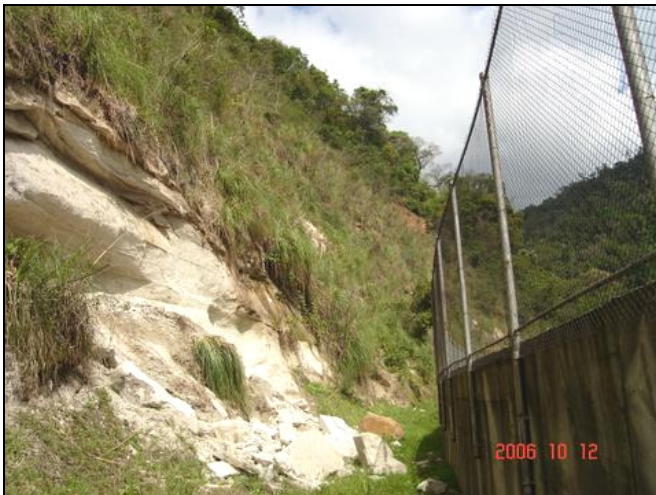
Figura 20: Queda de bloco no arenito Rio do Rasto e deslizamento do basalto alterado. Encosta entre as duas Pontes (Rio Tigrinho e São João). Observa-se o muro de contenção nas margens da rodovia (com aprox. 3 m de altura) Fonte: Solange F. Vieira (outubro de 2006)
