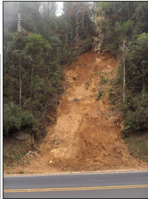
Figura 15: Deslizamento raso no basalto alterado. Localizado na primeira curva na descida da Serra, com aprox. 3,5 m de altura. Foto: Solange F. Vieira (Março de 2007)
