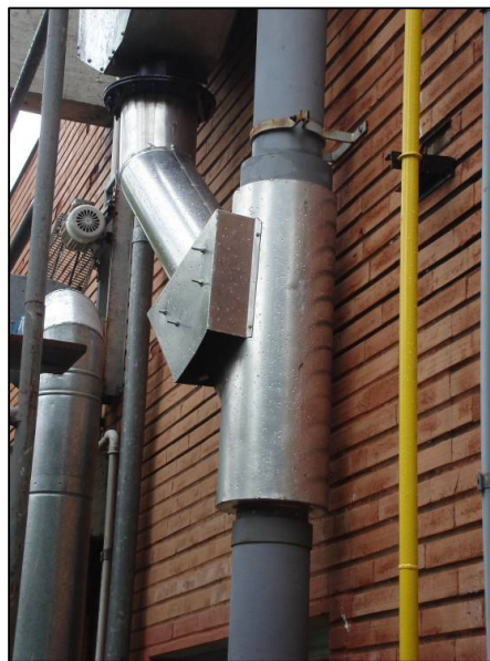
Figura 3.9 – Direcionador de fluxo montado na chaminé da microturbina.
