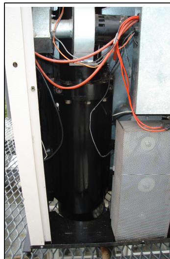
Figura 3.13 – Camisa de aquecimento do gerador instalada na máquina de absorção.
