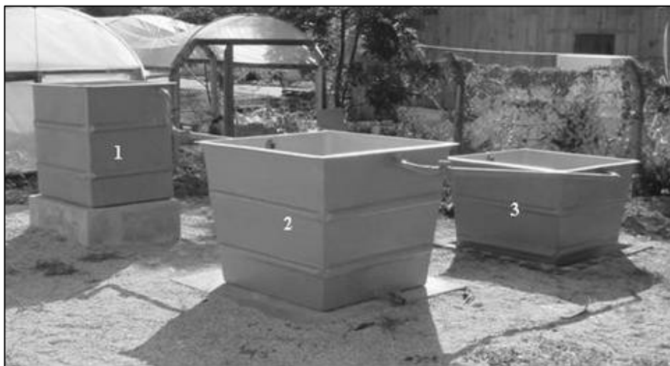
Figura 3.9. Unidades de Tratamento: 1 – Lagoa Anaeróbia; 2 – Lagoa Facultativa; 3 – Lagoa de Maturação.
