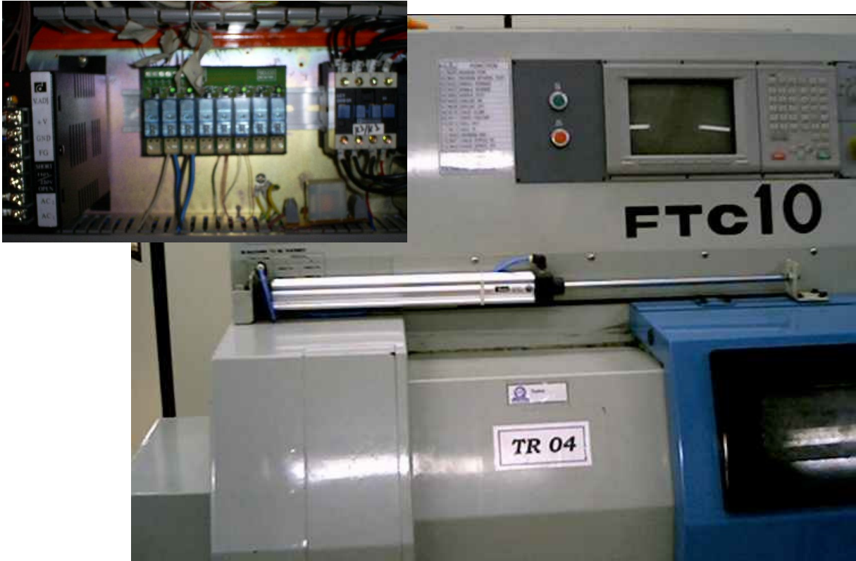
Figura 5.10. Cilindro pneumático, porta do torno e banco de relés auxiliares (no detalhe).
