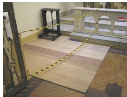
Figura 96 – O assoalho em marchetaria interditado devido o desnível do piso Fonte: Acervo da autora, 2006.
