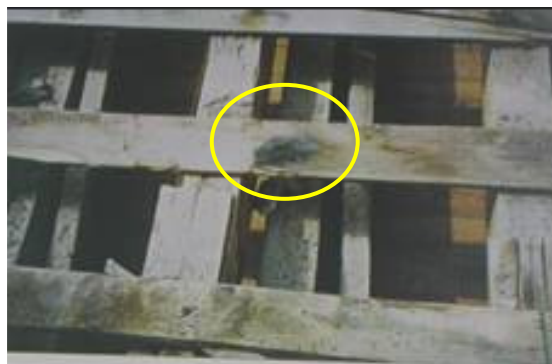
Figura 65 - Imagem da cobertura da Catedral, no destaque mancha de carbonização- 01/08/2000. Acervo FCC- Dir. de Patrimônio/ Relatório: fev./2001
