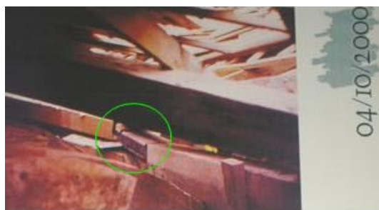
Figura 67 - Imagem da peça metálica inserida na perna da tesoura- 04/10/2000 Acervo FCC- Dir. de Patrimônio (relatório fev/2001)
