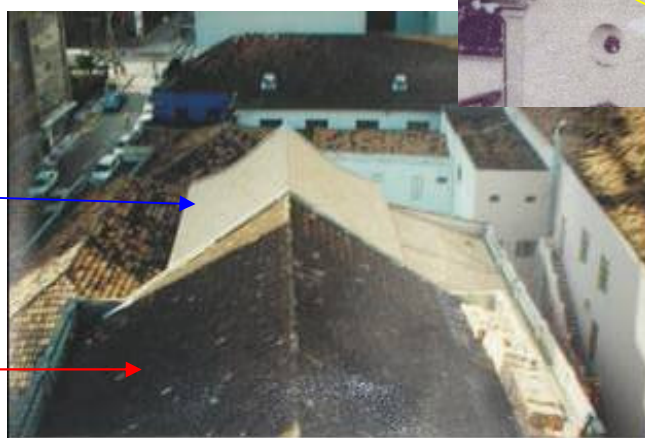
Figura 68 - Visualização do telhado com as telhas novas e antigas. No detalhe como era a cobertura original da Matriz.
