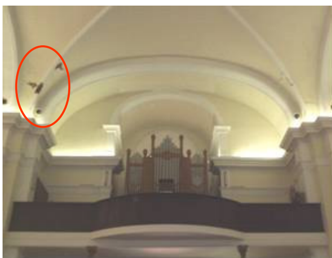
Figura 78 - Forro de estuque da nave, com fissuras e desprendimentos. Local: Nave Central da Catedral, acima do coro. Fonte: Acervo da autora, 2004
