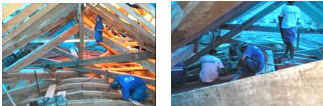
Figura 81- Trabalhos de limpeza do forro de estuque. Com a remoção das peças de madeira da estrutura da cobertura que estavam danificadas.
