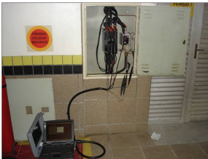
Figura 29 – Equipamento de medição da curva de carga instalado no circuito principal de alimentação do prédio.
