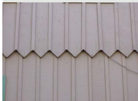
Figura 3.2 Detalhe da parede de tábua e mata-juntas. Casa Erbo Stenzel, parque São Lourenço, Curitiba-PR. Foto do autor, 2005
