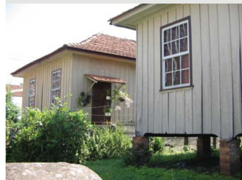
Figura 4.39 Detalhe do acabamento do encontro da tábuca com o pilarete de embasamento. Conjunto de casas Rua Pe. Anchieta. Foto do autor, 2006.
