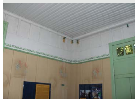
Figura 3.87 Detalhe da meia-cana do forro. Casa Erbo Stenzel, parque São Lourenço, Curitiba-PR. Foto do autor, 2005
