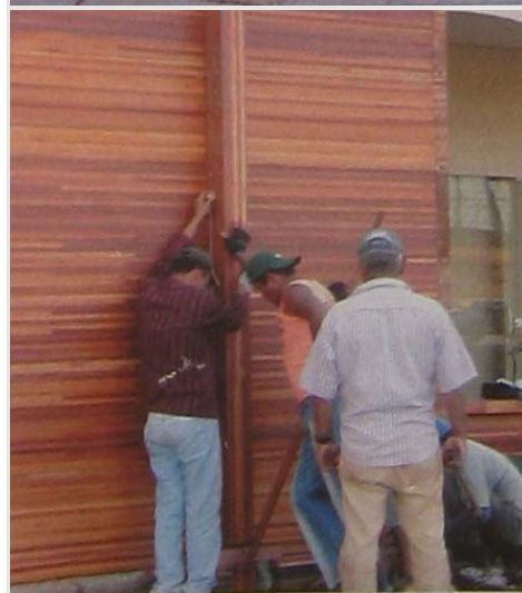
Figura 6.67 e Figura 6.68 Detalhe do painel e foto da montagem. Fonte: Revista Arquitetura e Construção, novembro de 2005.
