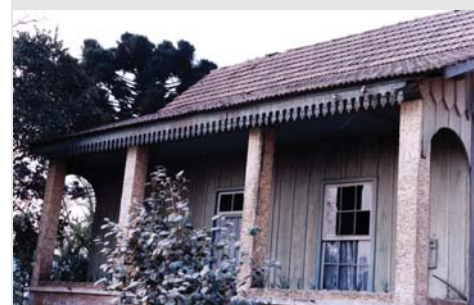
Figura 2.17 Detalhe dos lambrequins e soltura do oitão, ambos funcionam como proteção as intempéries aumentando a longevidade da construção. Foto Marialba Gaspar Rocha Imaguire, sem data
