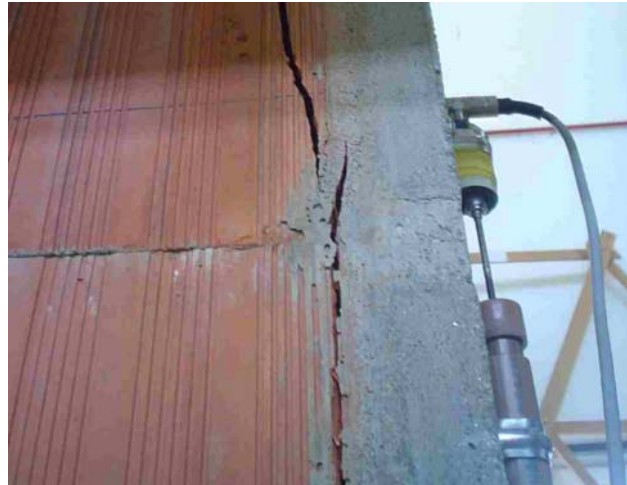
Figura 59 – Descolamento apresentado na interface bloco e argamassa armada
