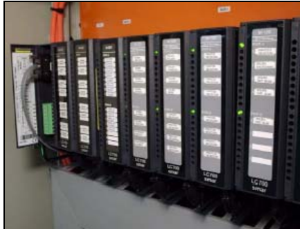
Figura 3.10 Controlador Lógico Programável LC700
