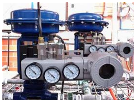
Figura 3.9 Válvulas e posicionadores fieldbus
