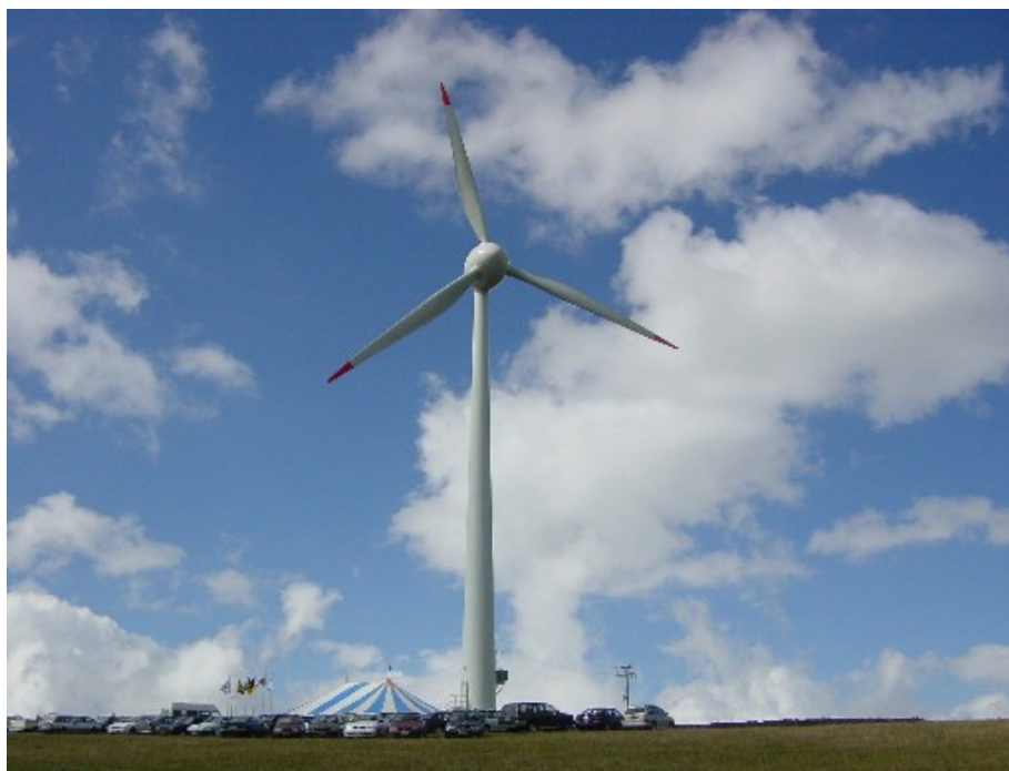
Figura 2.1 – Aerogerador de 600 kW da Wobben Windpower [3].
