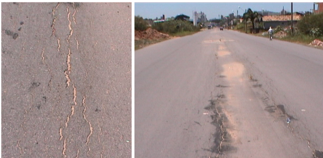
FIGURA 88. Deformação do pavimento das vias.
