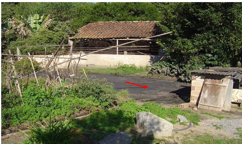
Figura 10 - Esterqueira transbordando e inadequadamente construída, com buraco aberto no solo sem revestimento contra a infiltração.
