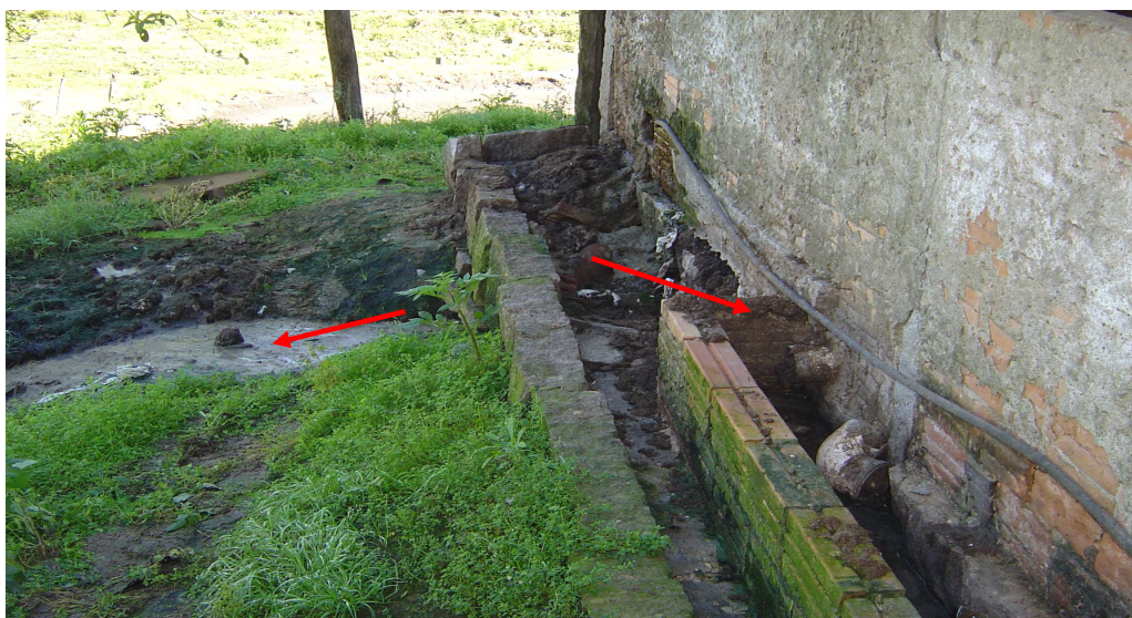
Figura 12 - Pocilga danificada com saída de dejetos diretamente nos rios
