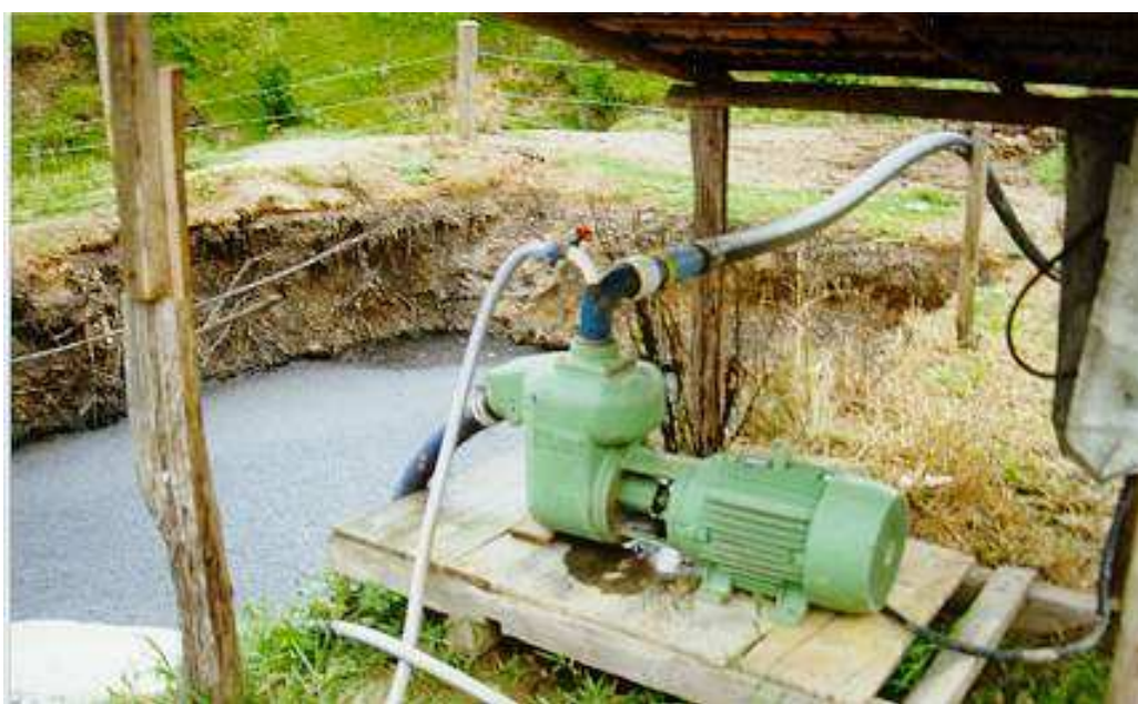
Figura 13 - Espalhamento dos dejetos por meio do sistema de moto-bomba
