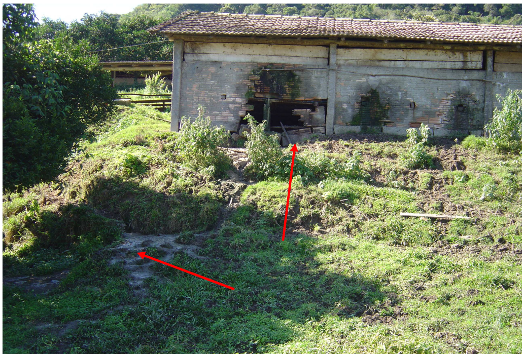
Figura 9 - Granja em estado de conservação precário com escoamento dos resíduos na rede de drenagem que encontra-se bem próxima.
