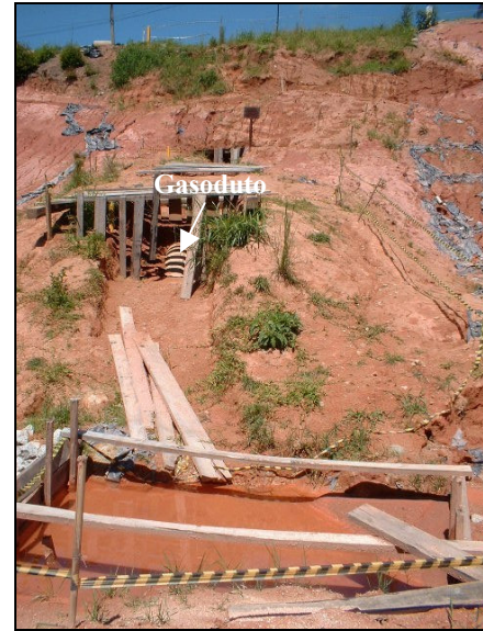
Figura 12 – Vista da tubulação do gasoduto sob o talude. Proteção provisória do duto.
