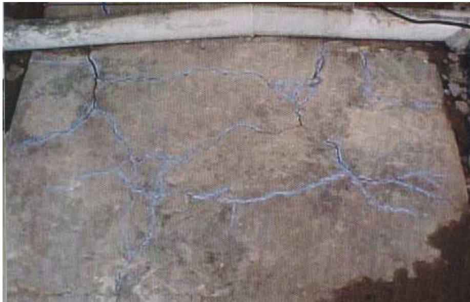
Figura 2.2: Fissura Tipo mapa em bloco de fundação (Fonte: Revista RECUPERAR nº65)
