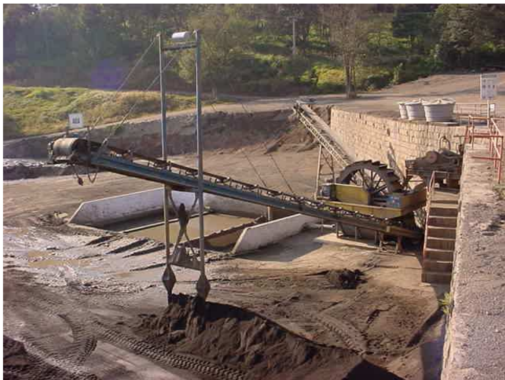
FIGURA 11 - Operação de limpeza do tanque de decantação
