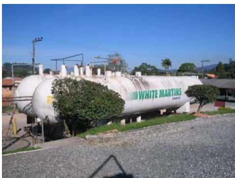
Figura 37: Tanques de armazenamento do CO_2 .
