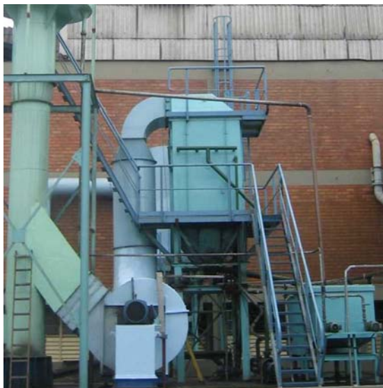
Figura 27: Lavador de gases cujo efluente líquido é reaproveitado.
