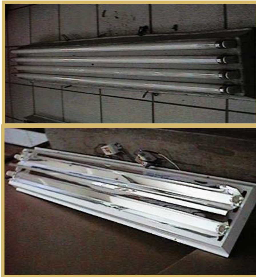
FIGURA 7 - RETROFITTING EM LUMINÁRIAS DO CEFET/SC – UNIDADE FLORIANÓPOLIS
