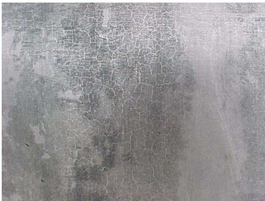
Figura 3.4 – Foto mostrando região da coluna afetada por CST, vendo-se as marcas de trincas superficiais ramificadas
