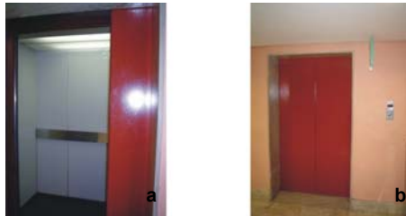
Figura 18: a/b) Vista interna e externa do elevador destinado ao público, mostrando que o mesmo não está de acordo com as especificações da NBR9050 em relação à sinalização tátil.
