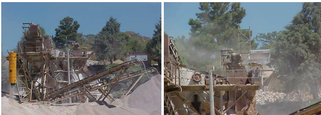
Figura 16: Condições de poeira a que estão submetidos trabalhadores e a população local. Salienta-se a presença de um operário no centro da foto à direita, operando o equipamento, sem a máscara para filtrar o ar nem protetor auricular.
