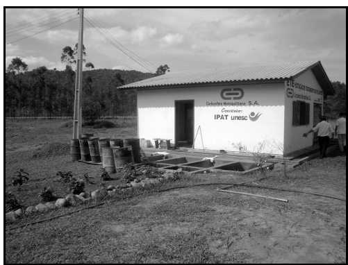
Figura 16 – Estação de tratamento piloto da Carbonífera Metropolitana S.A.
