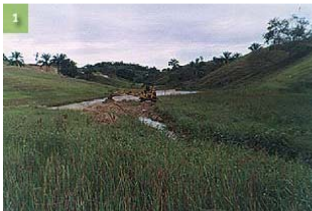
FIGURA 52. 1. Curso d'água totalmente assoreado, iniciando o processo de recuperação, desassoreamento e proteção.
