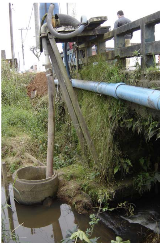
Figura 25 – Captação de água em Agronômica é feita por meio de bombas elétricas. (Foto: Guarim Liberato Junior).
