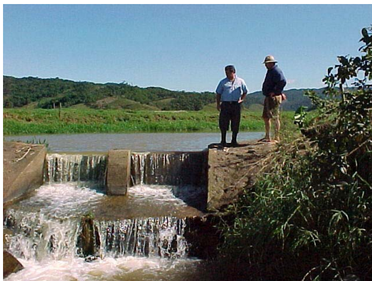
Figura 15 – Barramento de concreto com vertedor dotado de comportas para controle do nível da água na Sociedade de Vale Arraial. (Foto: Guarim Liberato Junior, 2002).
