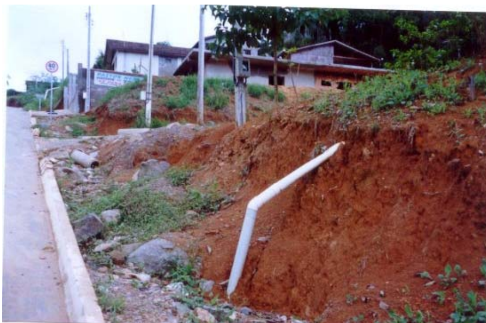
Foto 17 :Esgoto Pluvial e água servida, pode provocar problema de deslizamento. Localização: Jardim Germânico –Bairro Itoupavazinha .
