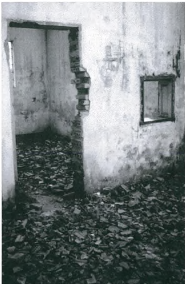
Figura 6 – Fotografia tirada por mim em 22 de julho de 2001. Imagem do interior da estação, mostrando a bilheteria e a porta para a entrada e saída dos funcionários. Os estilhaços de telha pelo chão dificultam o trânsito dentro da construção.
