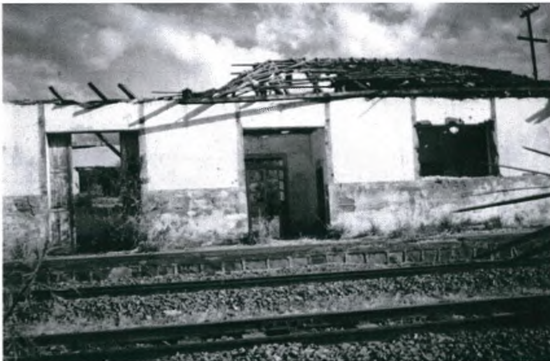
Figura 2 – Fotografia tirada por mim em 22 de julho de 2001. A proximidade da imagem ajuda uma melhor avaliação do estado de deterioração da estação. É possível ver que o interior da construção também se encontra em péssimas condições.
