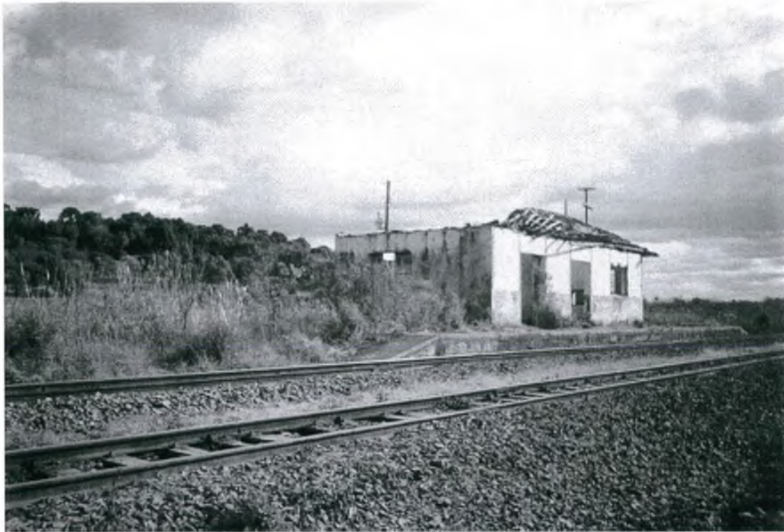
Figura 1- Fotografia tirada por mim em 22 de julho de 2001. No primeiro plano os trilhos. A imagem permite visualizar que o telhado ruiu, a ausência de portas e janelas e as manchas na pintura.
