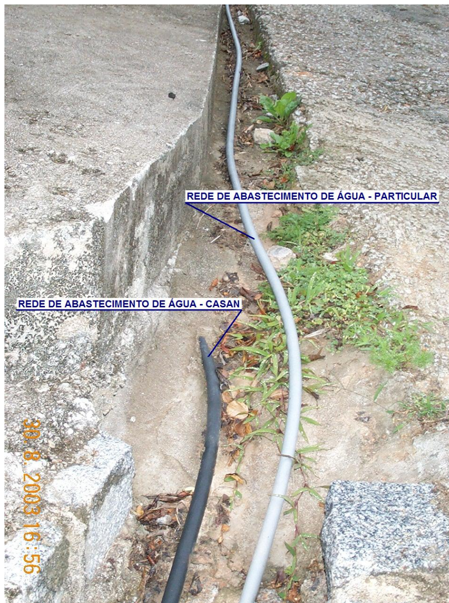
Figura 6 – Redes de abastecimento CASAN e particular convivendo lado a lado, fato amparado pela lei 2.193/85.
