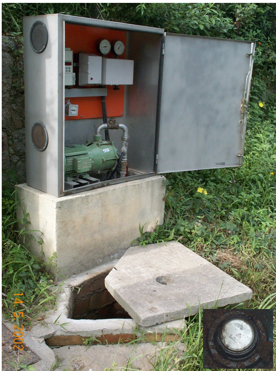
Figura 13 – Foto ilustrativa do booster com macromedidor.
