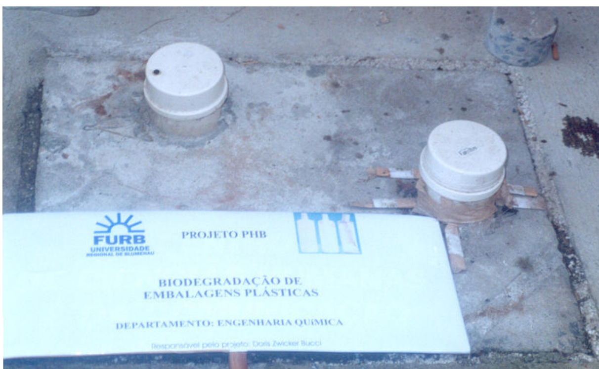
Figura: 3.15: Local do Meio VII – Caixa de gordura da cantina da FURB
