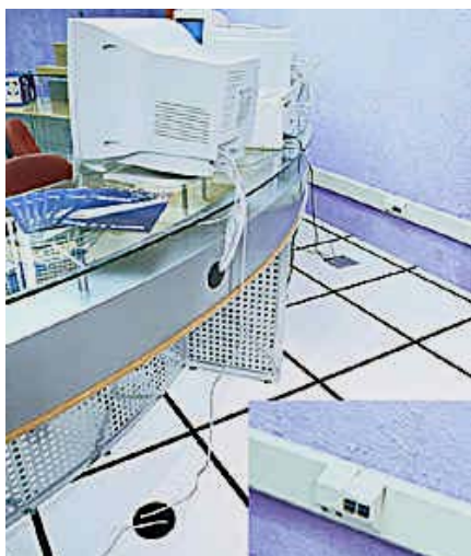
Fig. 37 Canaleta metálica da "MOPA"
