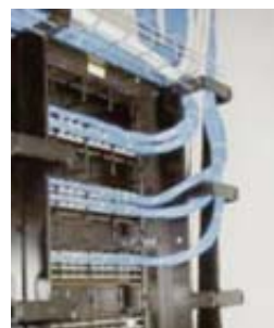
Fig. 56– Vista traseira de um patch panel instalado no rack
