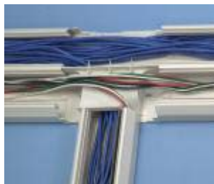
Fig. 42– Compartilhamento de cabeamento elétrico e de dadosEletrocalhas metálicas
