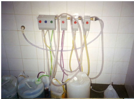
Central de dosagem de produtos químicos
